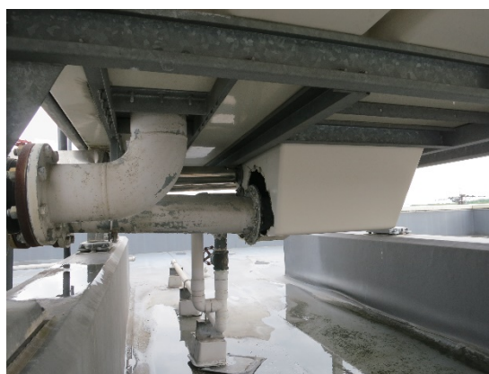
写真 4-27 冷却塔と冷却水配管接続部の被害
