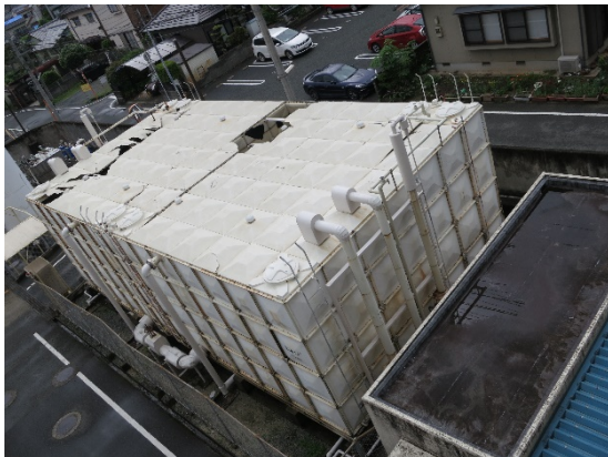
写真 4-21 受水槽天板の被害
