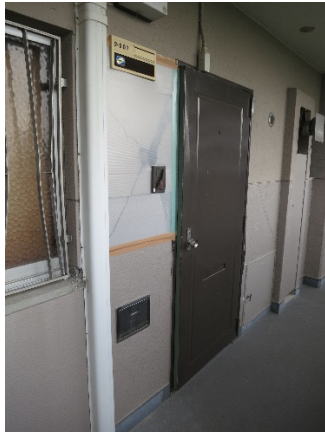
写真 4-7 開閉障害が発生した玄関扉
