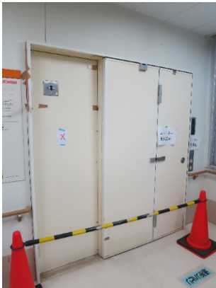
写真 4-12 開閉障害の発生した防火戸
