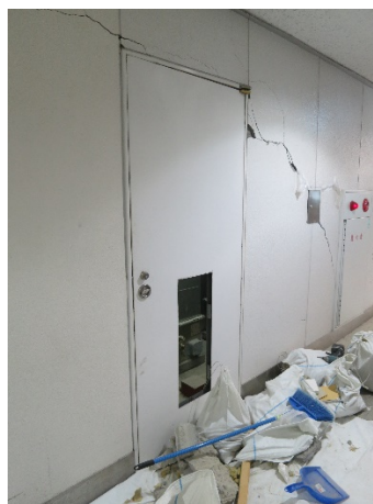
写真 4-4 開放できなくなった防火戸
