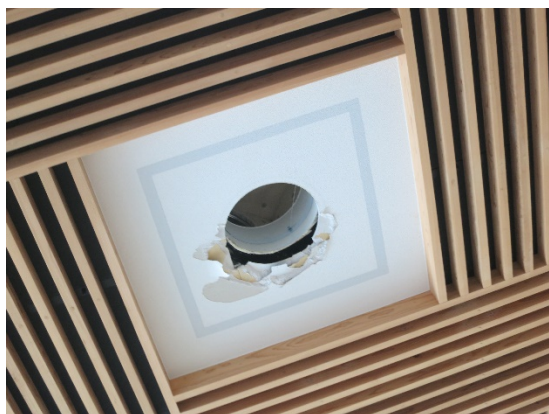
写真 4-1 天井吹き出し口の被害
