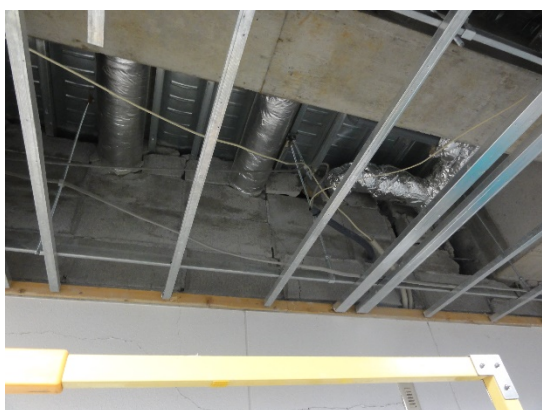
写真 4-5 ブロック壁（天井裏界壁）の被害
