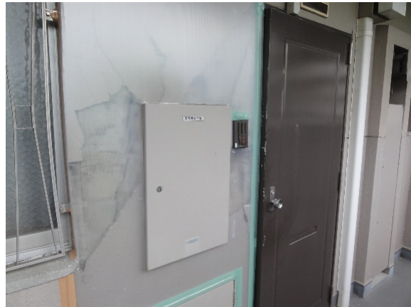
写真 4-8 方立て壁のせん断被害（等級IV）
