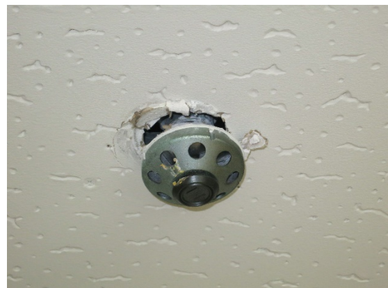
写真 4-24 スプリンクラーヘッドの抜け
