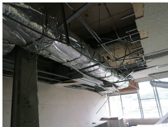
写真 4-29 空調ダクトの被害
