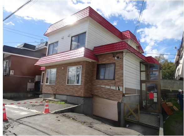
写真 5.2 地盤変状により基礎・上部構造ともに損傷したように見える戸建住宅
