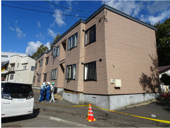
写真 5.1 地盤変状により基礎・上部構造ともに損傷したように見える共同住宅
