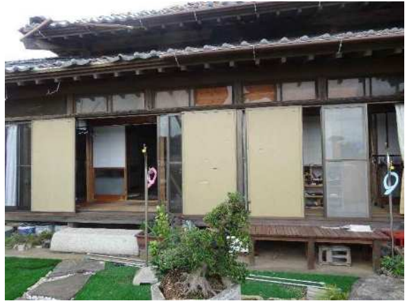
写真 3.1.51 住宅 K の壁面の被害（南東側）
