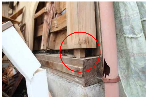
写真 3.1.12 抜け出した柱のほぞ
