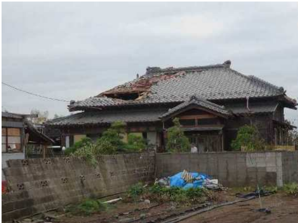
写真 3. 1. 48 住宅 K の屋根の状況 (南東側)
