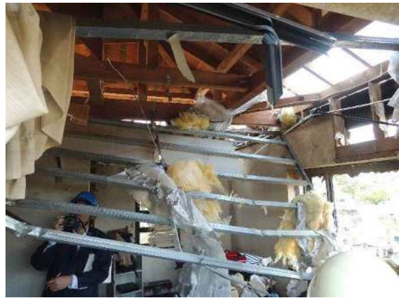
写真 3.1.45 天井材の落下
