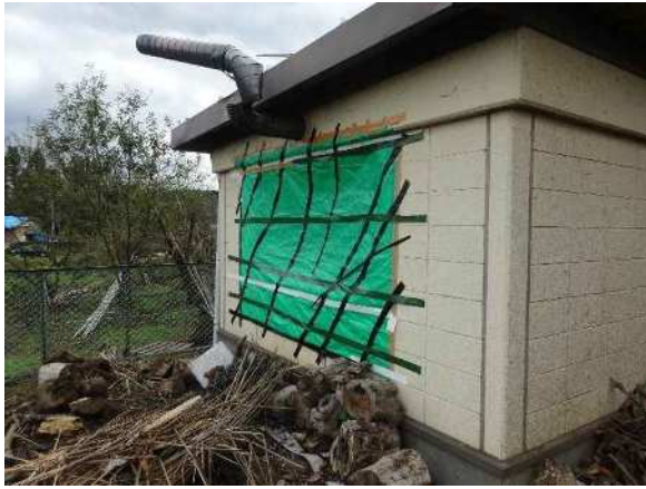
写真 3. 2. 9 陶芸室の窓ガラスの破損
