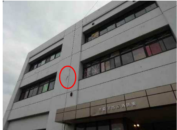
写真 3. 2. 14 外壁や窓ガラスの被害
