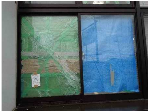
写真 3. 2. 15 窓ガラスの被害と養生状況
