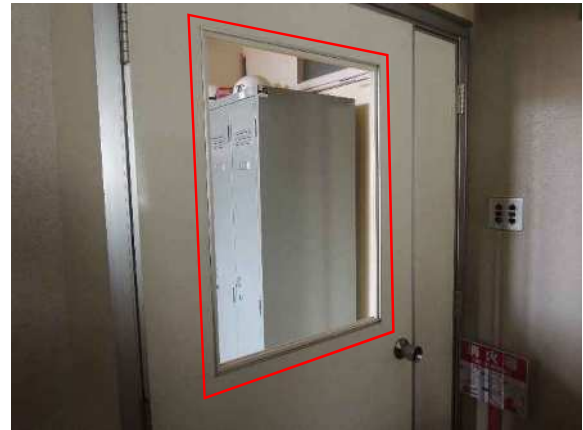
写真 3. 2. 12 市津支所内部のドアにはめ込まれたガラスの破損箇所
