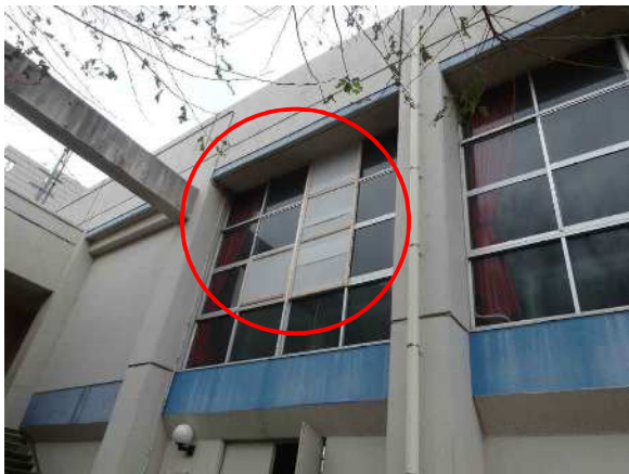
写真 3.2.7 体育室の破損した窓ガラス
