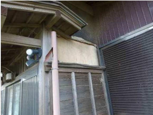
写真 3.1.52 玄関脇の被害
