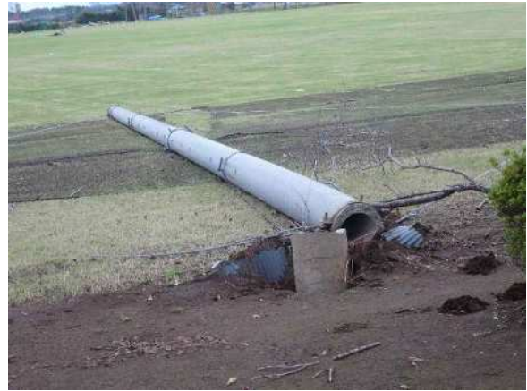
写真 3.3.19 柱の折損状況
