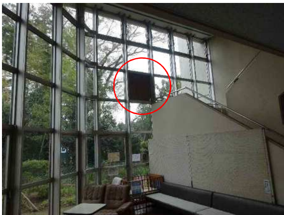
写真 3.2.1 破損した窓ガラスの状況
