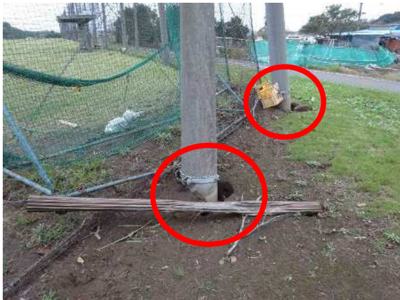
写真 3.3.20 支圧による柱のずれ
