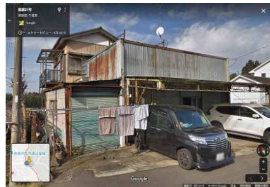
写真 3.1.22 倒壊した住宅 (Google ストリートビュー (2019 年 3 月撮影) より)
