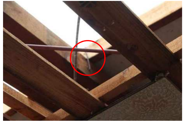
写真 3.1.8 小屋組のかすがい
