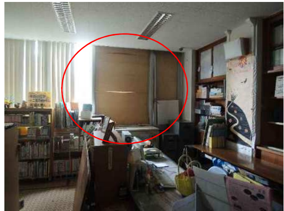
写真 3.2.6 台風第 15 号の強風で 破損した窓ガラスの範囲
