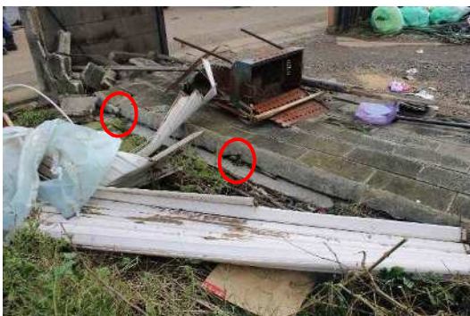
写真 3.3.14 ブロック塀の被害(3) (丸囲みは縦筋)
