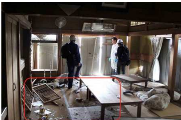
写真 3. 1. 17 ガラス等が飛散した室内
