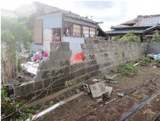
写真 3.3.12 ブロック塀の被害(1)
