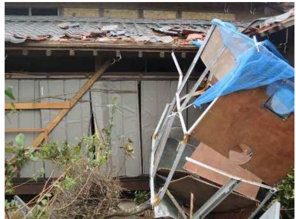
写真 3. 1. 14 農業用工作物の雨戸への衝突状況
