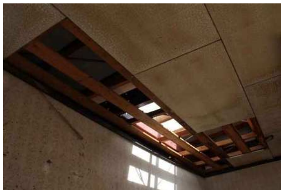
写真 3.1.4 天井材の損傷状況
