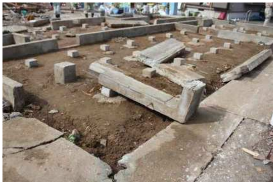
写真 3.1.31 残った無筋基礎 (南東側で折損)
