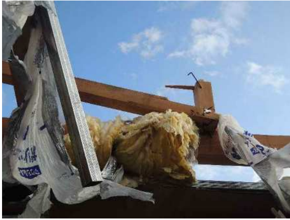
写真 3. 1. 47 小屋束の状況
