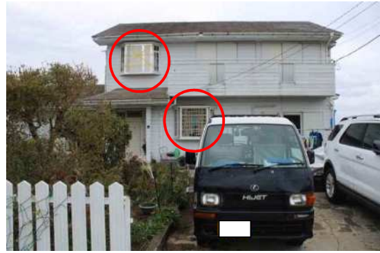
写真 3.1.24 南面の窓の被害
