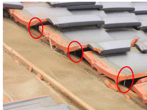
写真 3.1.28 釘打ちされた瓦
