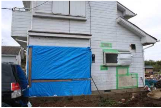
写真 3.1.23 東面の窓・壁の被害
