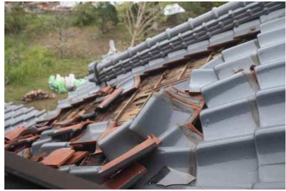
写真 3.1.20 屋根瓦の脱落
