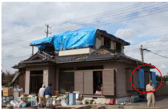
写真 3.1.25 南東側から見た雨戸、瓦の被害
