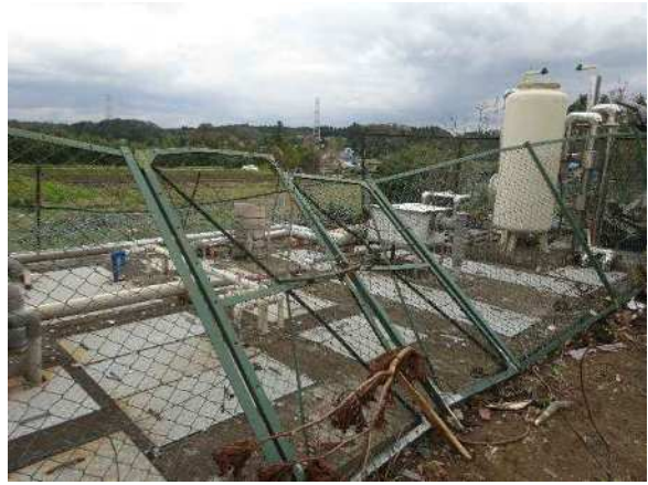
写真 3. 2. 10 フェンスの倒壊
