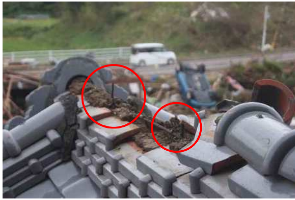
写真 3.1.19 鉄筋で留め付けられた棟瓦
