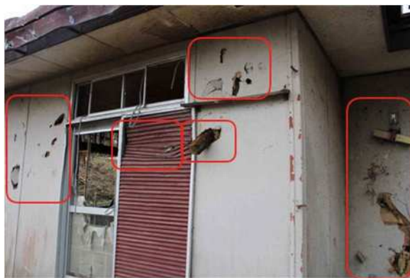
写真 3.1.6 飛来物の衝突や貫通 (東面 1F)
