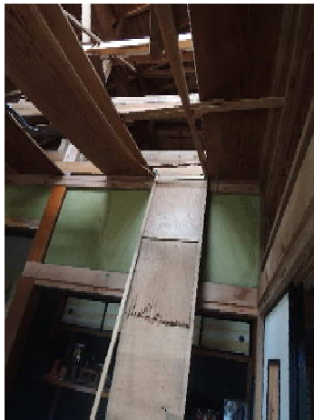
写真 3.1.54 室内側の被害(2)
