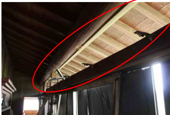
写真 3. 1. 15 脱落した欄間
