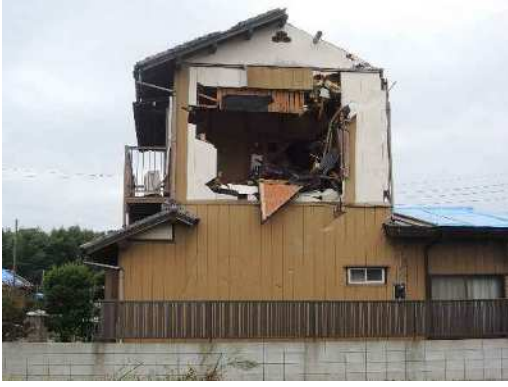
写真 3. 1. 56 北東側の外壁の損壊状況
