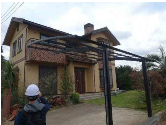
写真 3.3.22 カーポートの被害
