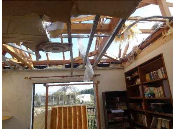
写真 3.1.46 野地板の飛散と天井材の破損
