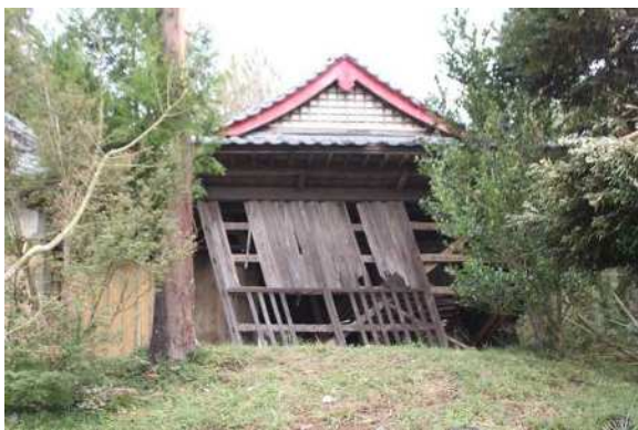
写真 3. 3. 1 本殿の被害状況
