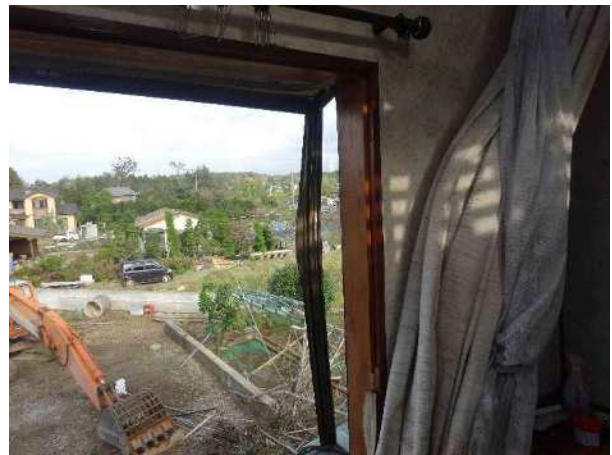
写真 3. 1. 36 サッシの変形
