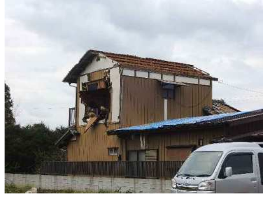
写真 3. 1. 57 北東側の外壁の損壊と北西側の屋根での野地板の飛散状況
