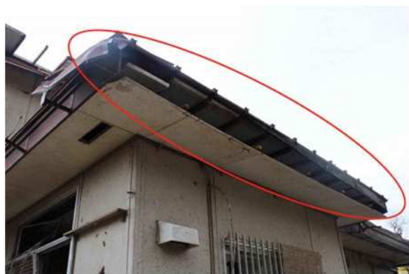
写真 3.1.5 屋根軒先部の損傷状況
