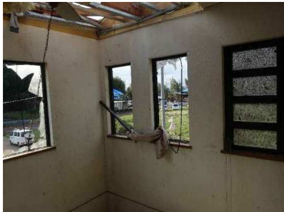
写真 3.1.44 吹き抜けでのガラスの破損
