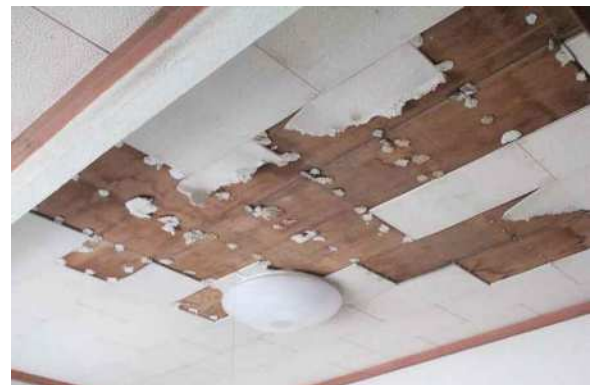
写真 3. 1. 18 天井の雨漏り被害
