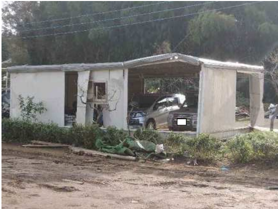
写真 3.3.8 車庫 C の損傷状況
