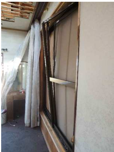
写真 3. 1. 37 室内側に変形した雨戸とサッシ
