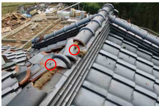
写真 3.1.27 棟瓦の割れ (赤丸部は銅線)
