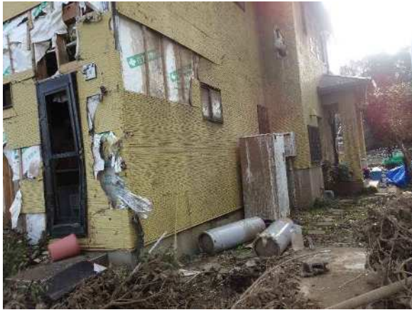
写真 3.1.41 外壁材の剥離(北側)
