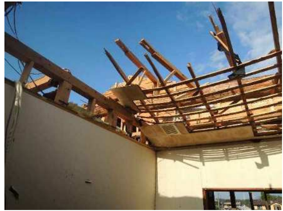
写真 3. 1. 34 小屋組ごと飛散した 屋根の範囲の状況
