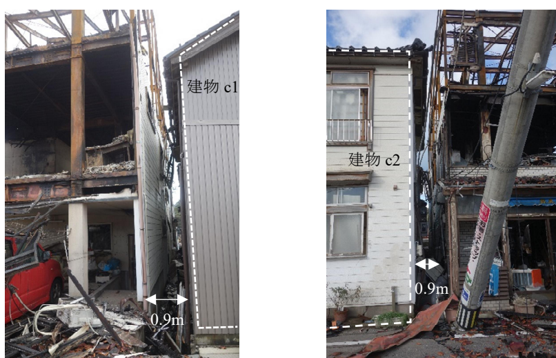
(ア) 建物 c1 の西側から北面を見た様子 イ) 建物 c2 の東側から北面を見た様子
