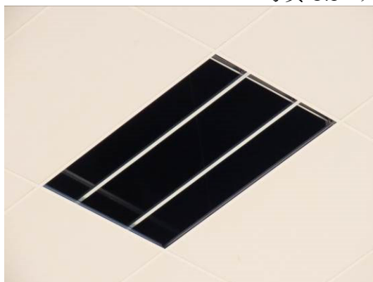
写真 O.2 天井材が脱落した部分
