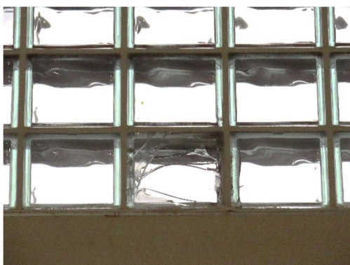
写真 H.4 ガラスブロックの破損
