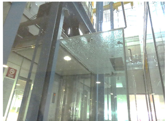
写真 N.10 エレベーターかごのガラス天板の破損
