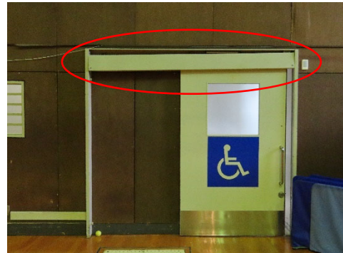
写真 K.7 建具のカバー材の外れ
