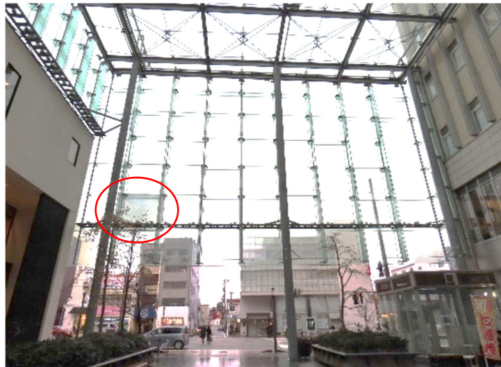
写真 P.1 壁面ガラス内観 (赤丸で囲った部分が割れたガラス)
