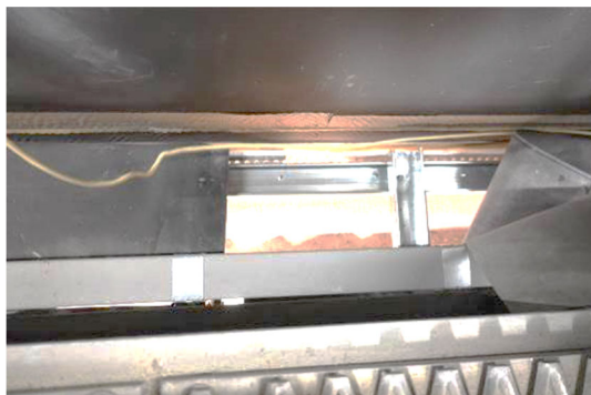
写真 F.8 天井板の落下した部分（上部）
