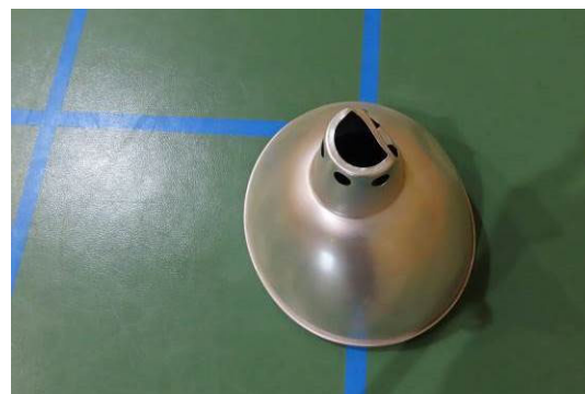
写真 O.5 落下した照明器具
