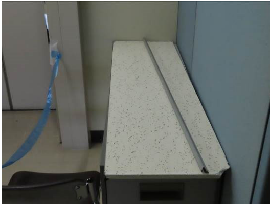
写真 A.8 脱落した天井部材
