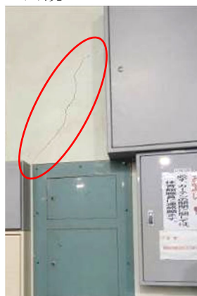
写真 L.4 壁面のひび割れ(屋内)
