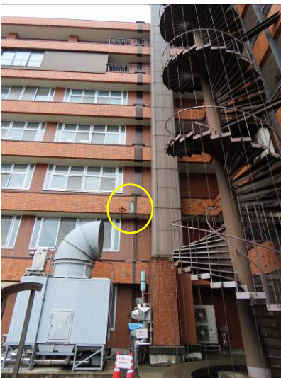
写真 A.10 エクspansionジョイント近傍 の外装材の剥離および落下
