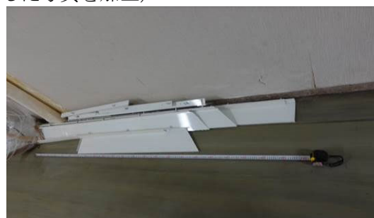
写真 A.3 脱落したカバー部材
