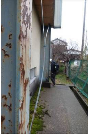
写真 K.4 ブレースの面外たわみ (外側)
