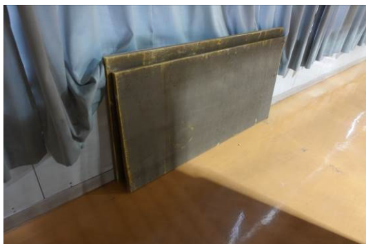
写真 D.4 脱落した天井板
