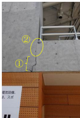
写真 J.2 アリーナ客席のひび割れ ①地震前からあったひび (補修痕あり)、 ② (丸部分) 今回の地震により発生したひび
