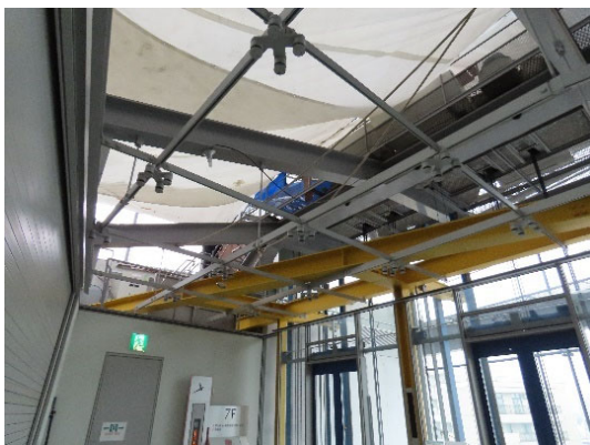
写真 N.11 エレベーターホールのガラス天板の破損 (撤去済み)
