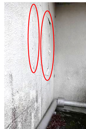
写真 L.5 壁面のひび割れ(屋外)
