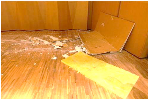
写真 F.12 脱落した側面反射板
