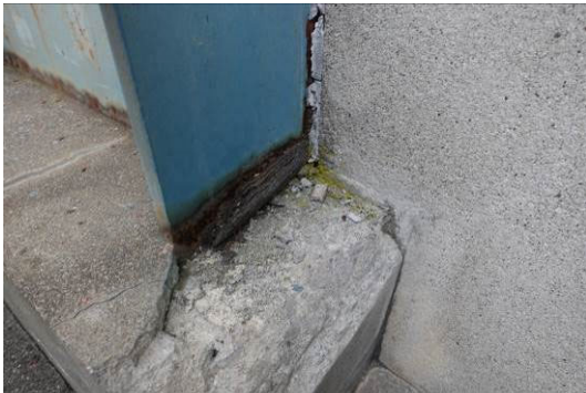
写真 K.6 柱脚の被害
