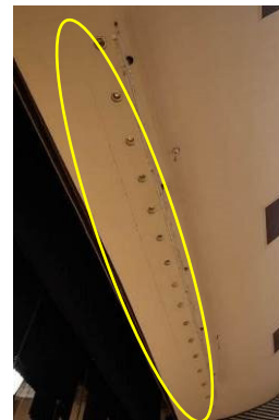
写真 Q.3 天井面材のひび割れ
