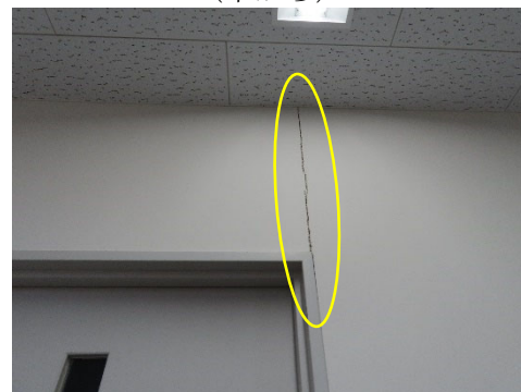
写真 I.5 内装材のひび割れ
