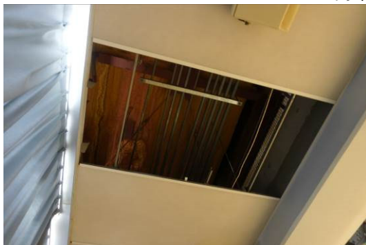
写真 D.2 ギャラリーの被害状況
