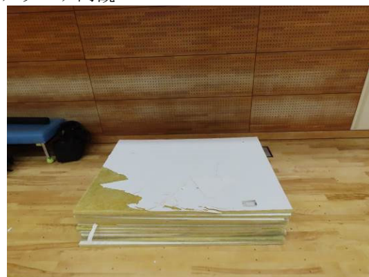
写真 O.3 脱落した天井材 (メインアリーナ)
