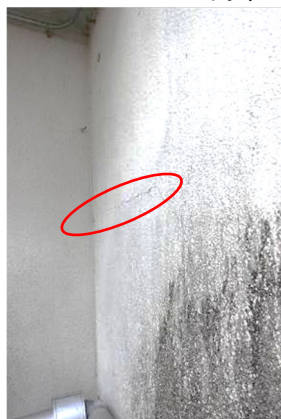
写真 L.3 壁面のひび割れ(屋外)
