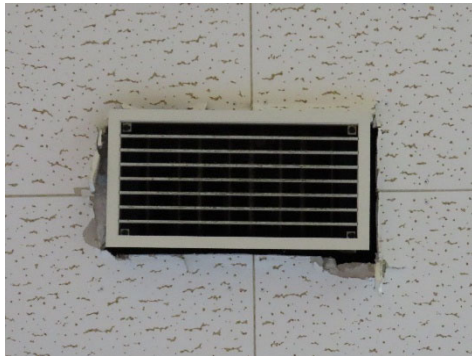
写真 G.8 換気口周りの天井の損傷
