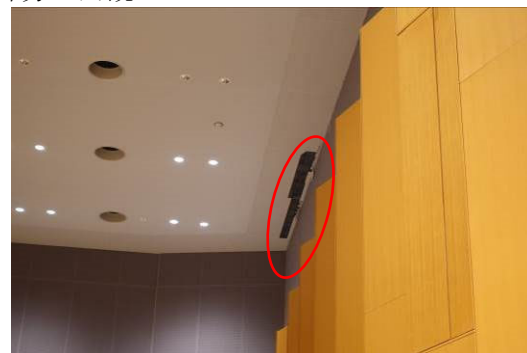
写真 F.3 被害状況
