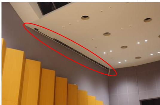
写真 F.2 被害状況
