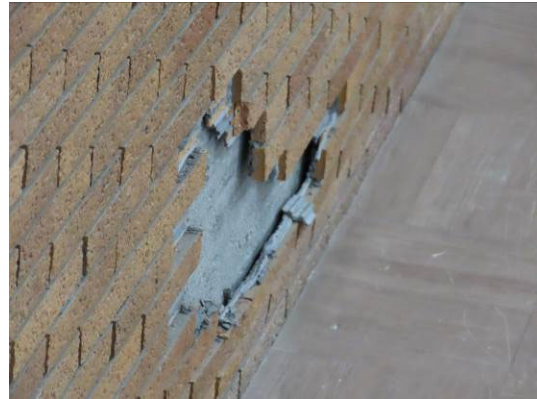
写真 A.9 内装材の剥離および落下
