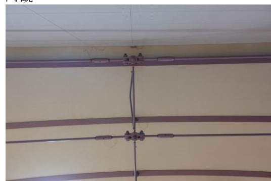
写真 I.3 梁の棟部にあたる鋼棒の被害状況 (下から)
