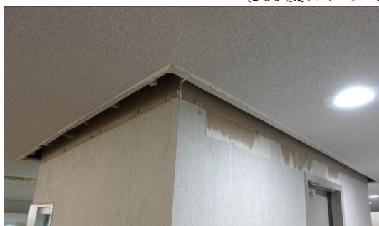
写真 A.2 天井周辺カバー材の被害状況
