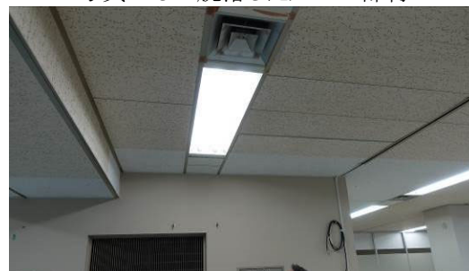
写真 A.5 4階のシステム天井 ※白色の部分は脱落后、応急措置済
