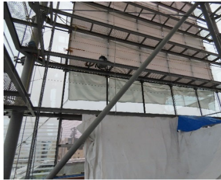
写真 N.5 ガラスの被害状況 (内観)
