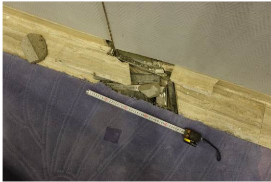
写真 F.14 エキспанションジョイント周りで の被害状況
