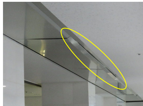
写真 Q.5 エキスパンションジョイントカバーの変形
