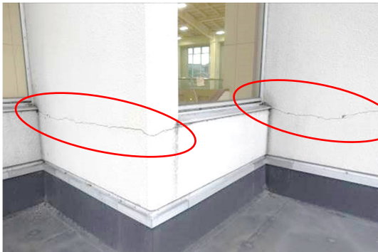
写真 G.2 外壁のひび割れ(外側)
