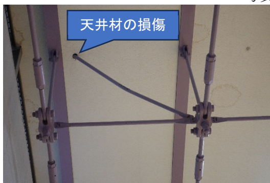
写真 I.2 梁の棟部にあたる鋼棒の被害状況 (横から)
