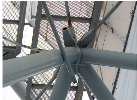
写真 N.8 支持部分の鋼材の脱落(近接撮影)
