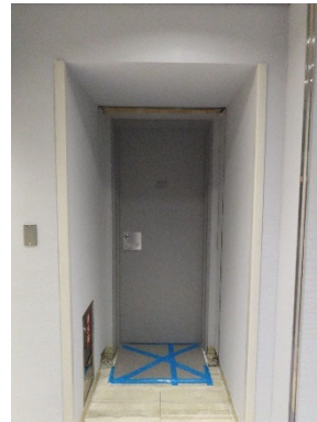
写真 F.15 エキспанションジョイント周りで の被害状況
