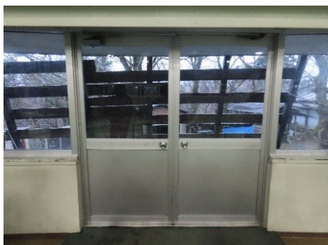
写真 L.6 割れたガラス(応急措置済)
