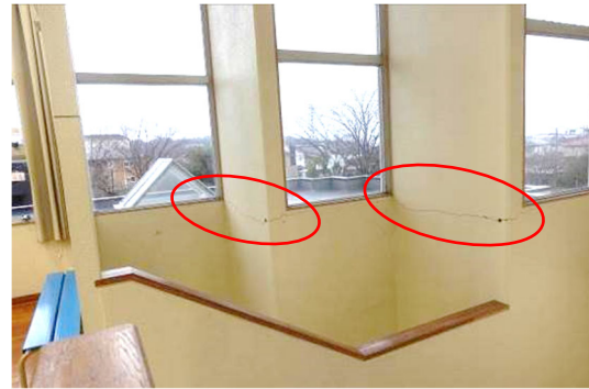
写真 G.3 間仕切り壁のひび割れ
