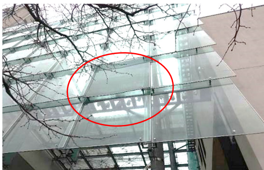
写真 P.2 壁面ガラスの被害状況
