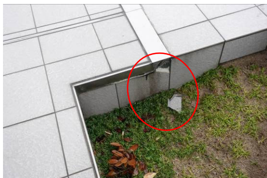
写真 M.1 免震層と外構の間のタイルの破損
