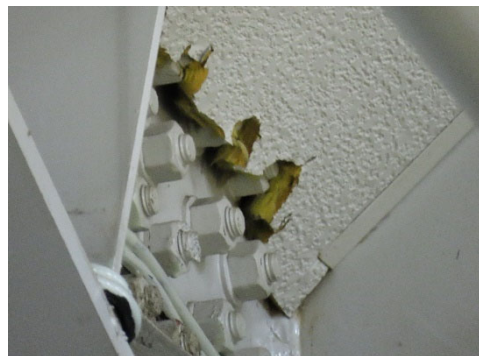
写真 J.3 ボードの損傷
