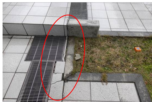
写真 M.2 外構部分の破損
