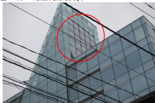
写真 N.3 ガラスの被害状況（外観）
