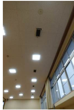
写真 G.7 換気口周りの様子
