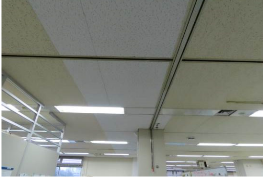
写真 A.6 4階のシステム天井 ※白い部分は脱落后、応急措置済
