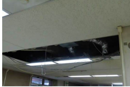
写真 A.7 3階のシステム天井 ※調査時点では応急措置は講じられていない
