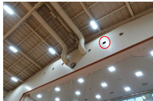
写真 G.5 ダクトや換気口の脱落
