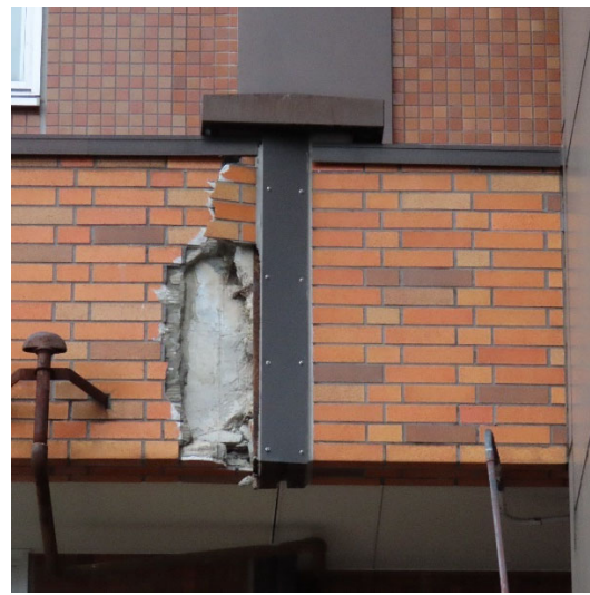
写真 A.11 エクspansionジョイント近傍 の外装材の剥離および落下 ※写真 A.10 の丸で囲った部分の拡大写真
