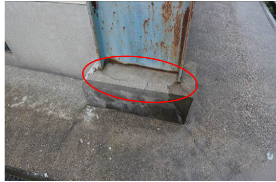
写真 K.5 柱脚の被害
