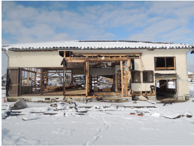
写真 1-1 津波による前面の被害 (珠洲市宝立町鶴飼)
