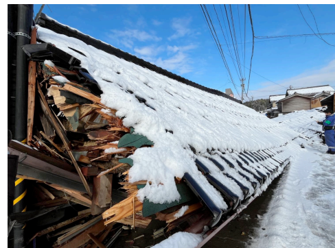
写真 2-2 倒壊した建築物の瓦屋根 (珠洲市宝立町鶴飼)
