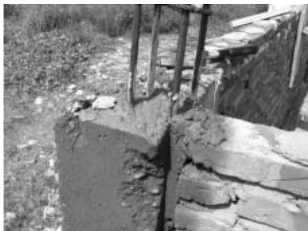
写真-17 鉄筋が大きく偏って配置されている
