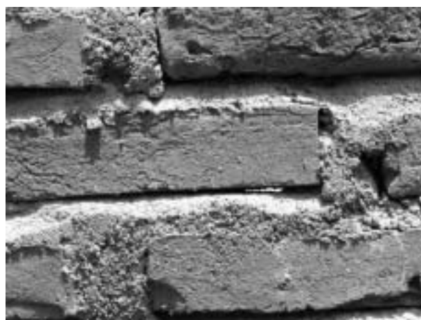
写真-20 レンガ積の状況 中央部は隙間から向側が透けて見える
