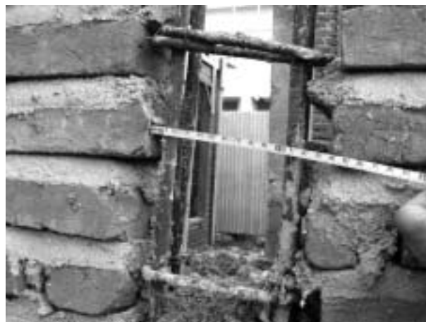
写真-25 断面寸法が不足。図-4のように壁と柱の間にアンカーが必要。
