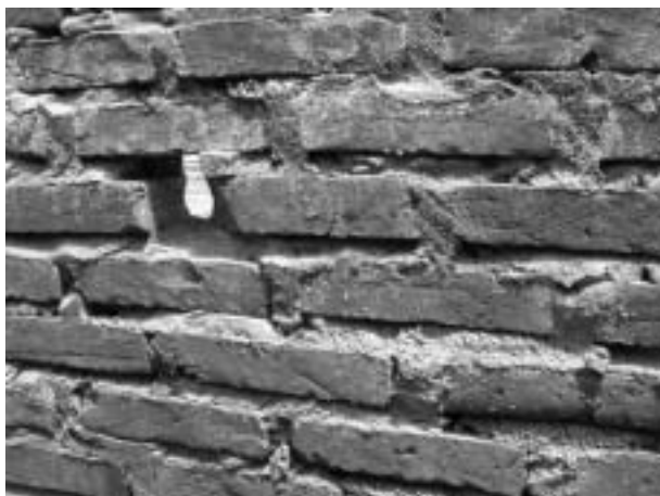
写真一21 割れたレンガ 目地も均等とはなっていない
