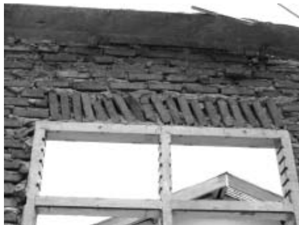
写真一22 窓の枠材 本来フラットアーチを形成すべき部分
