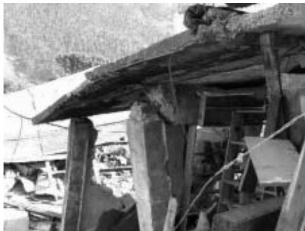
写真-27 ほとんどの例では、柱、梁などの破壊ではなく、その接合部の破壊により倒壊している。
