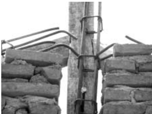
写真-24 配筋の状況 図-3のような施工が求められているが実際には実施されていない
