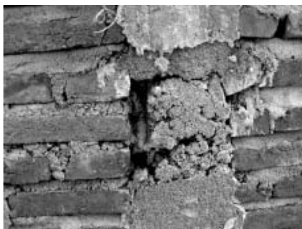
写真-19 コンクリートの打設状況 一部、鉄筋が露出している
