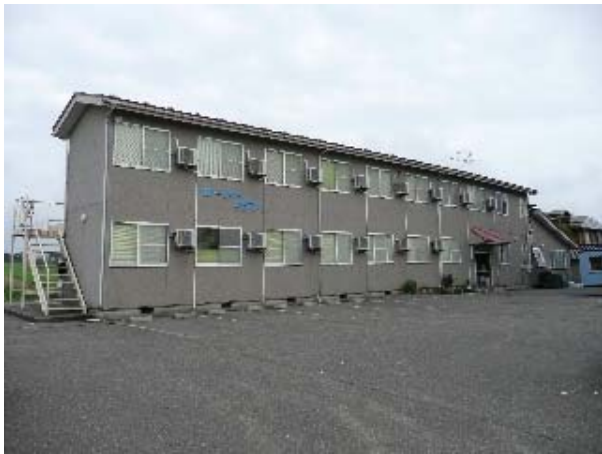
写真 5.57 一部損壊（裏手部分）した木造共同住宅
