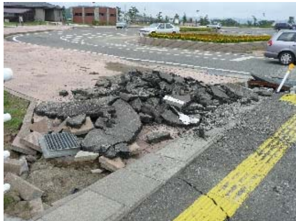
写真 5.46 鯖石川記念公園駐車場へ続く地面のひび割れ
