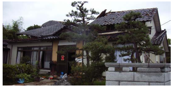
写真 5.4 小屋組の一部が崩壊する希少な被害例
