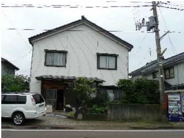
写真 5.21 残留変形が大きく残る住宅
