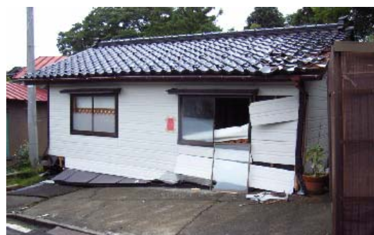
写真 5.2 新しい構工法でも倒壊した 1階を車庫等にした家屋
