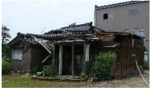
写真 5.30 2階が崩壊した例
