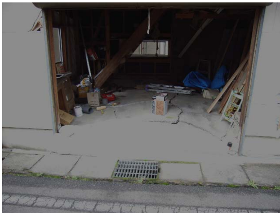
写真 5.7 写真 5.6 の土間コンのひび割れ
