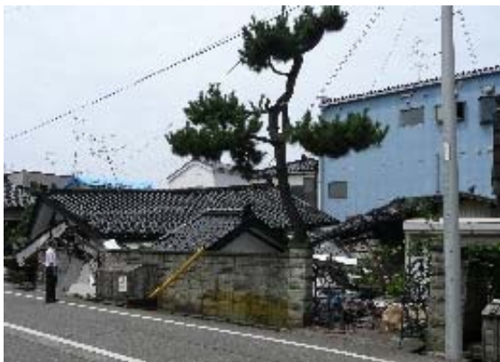
写真 5.31 一見新しい住宅に見える倒壊住宅
