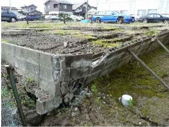
写真 5.43 駐車場地面のひび割れと擁壁の崩壊
