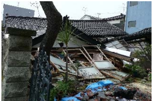
写真 5.32 写真 5.31 近景（土塗り壁の残骸が確認できる）
