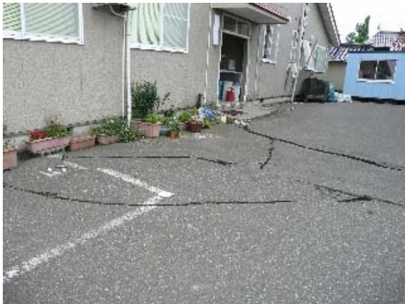
写真 5.45 写真 5.44 の北北東へ続くひび割れ
