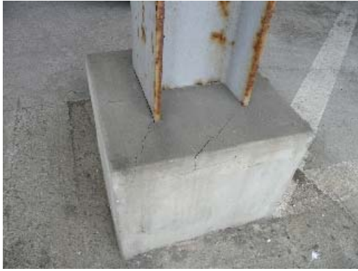
写真 5.40 写真 5.38 の鉄骨柱脚部分のコンクリートのひび割れ
