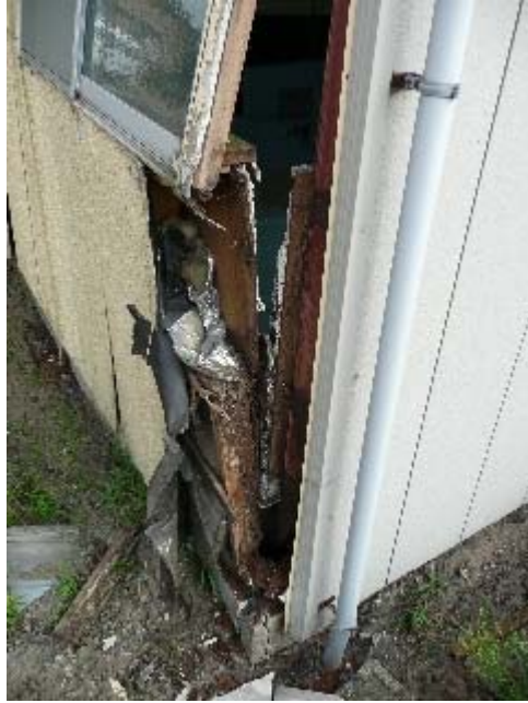
写真 5.56 写真 5.55 の裏側の被害
