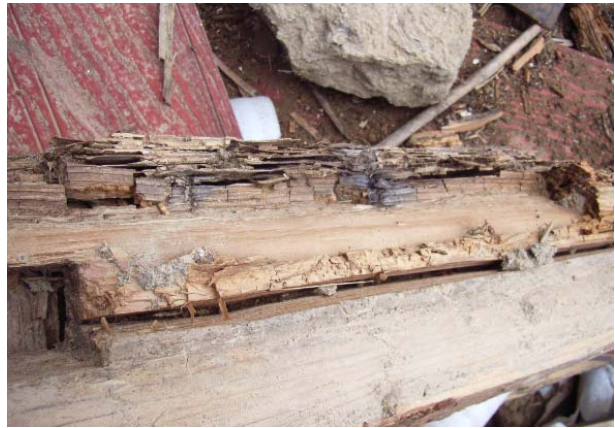
写真 5.16 写真 5.15 の建物の部材の腐朽・蟻害
