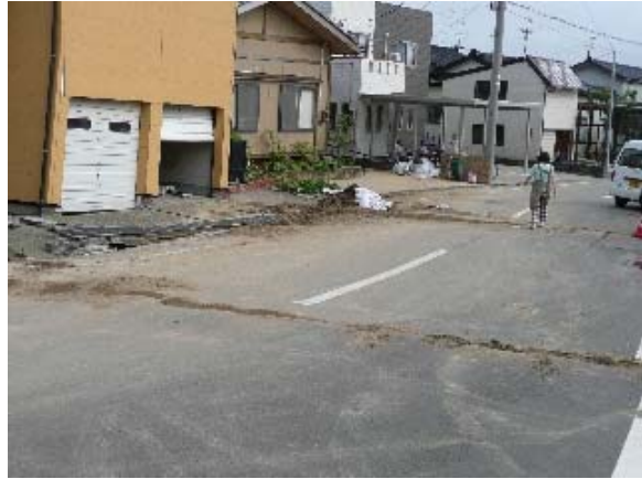
写真 5.44 アスファルトを貫くひび割れ (写真 5.43 の北東方向)
