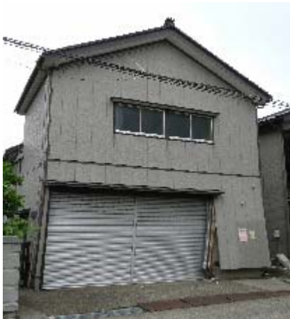
写真 5.41 1階が大きく傾いた車庫
