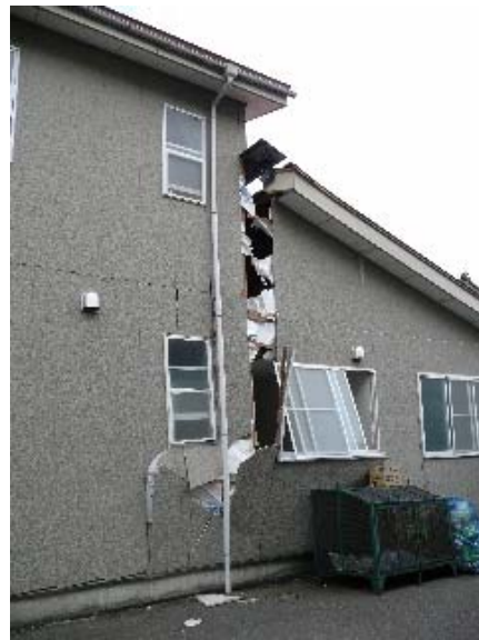
写真 5.58 写真 5.57 の下屋部分の継ぎ目部の破壊
