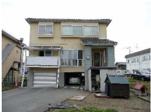
写真 5.54 地盤変状により大きな被害を受けた 高床式木造（1階部分 RC 造）
