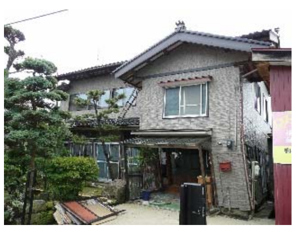
写真 5.20 残留変形が大きい住宅
