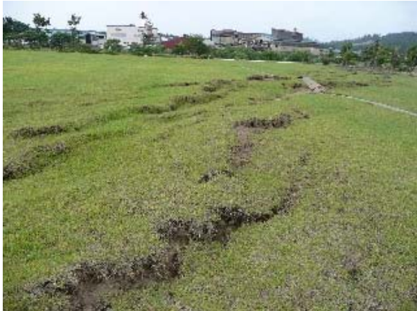
写真 5.49 鯖石川記念公園中央を貫くひび割れ
