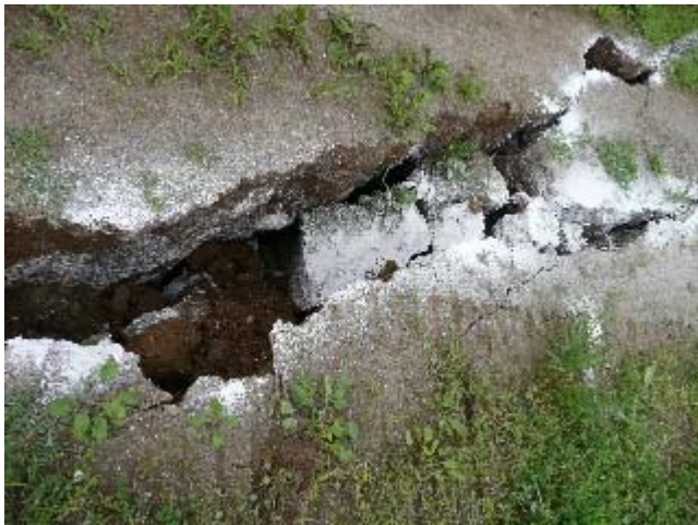
写真 5.51 鯖石川記念公園北側の土手を貫くひび割れ（深さ 1 m 以上）の北端部付近
