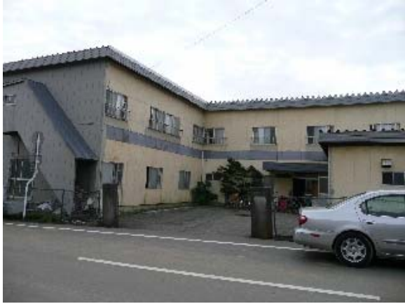
写真 5.55 一部損壊（裏手部分）した軽量鉄骨造
