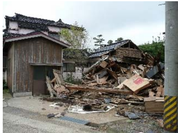
写真 5.37 車庫又は倉庫と推測される倒壊家屋
