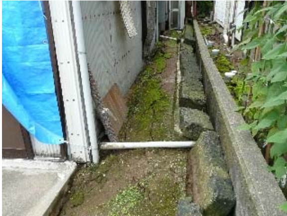
写真 5.25 写真 5.23 の敷地の変状
