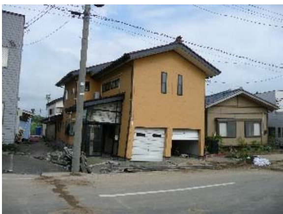
写真 5.53 地盤変状により大きな被害を受けた 木造住宅
