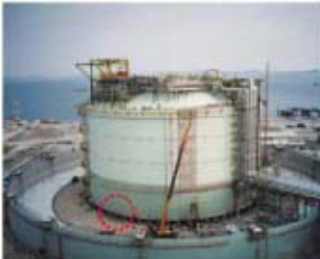
Figure 5.4.2 LNG storage tank
