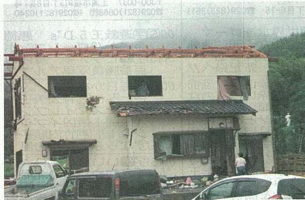
今年7月19日の突風で屋根の飛ばされた住宅(美作市撮影)
