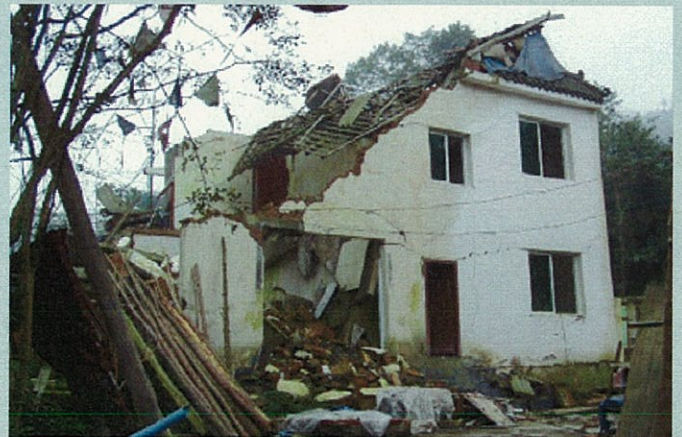
写真2. 煉瓦造建物の破壊(四川省都紅堰市)
