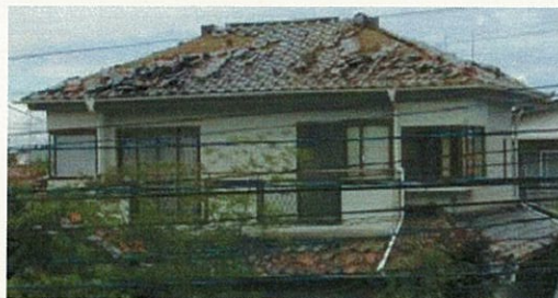
図4 地震後の瓦の脱落
