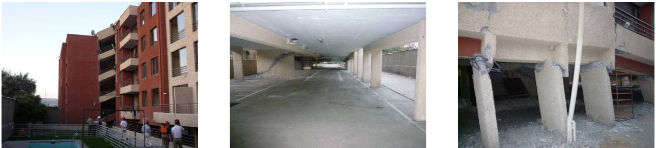
写真4 ピロティ建物の被害、ピロティ層 (1 階駐車場) の被害
