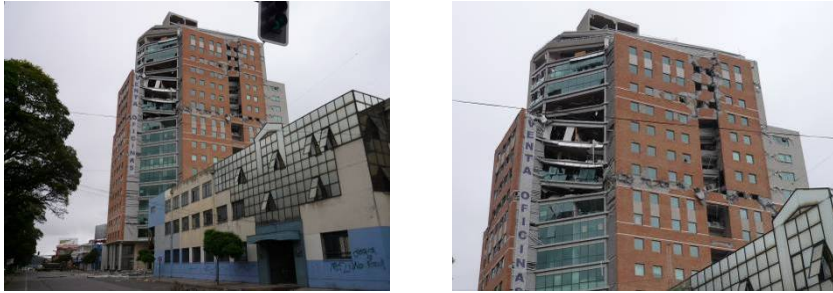
写真3 中間階で層崩壊した建物 (コンセプション市)
