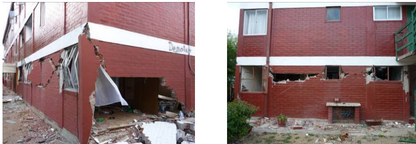
写真5 枠組組積造集合住宅建物の被害 (カウケネス)
