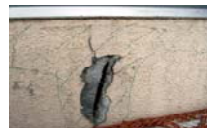
コンクリート爆裂部
