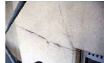
窓回りのひび割れ
