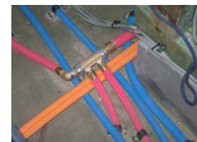
ヘッダー配管
