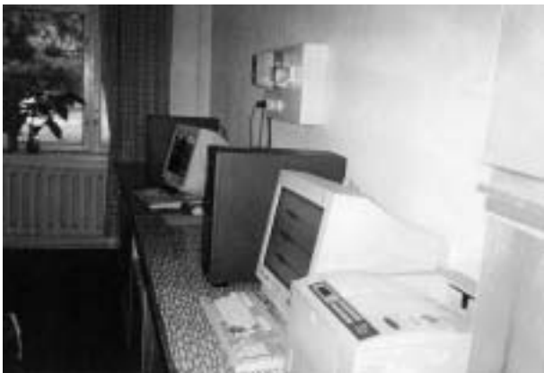
図 13 供与された高感度地震観測装置の収録部（終了時評価報告書より引用）
