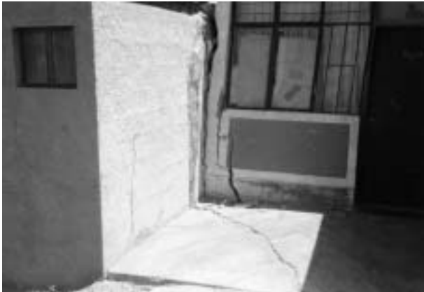
図 9 膨張土によって建物が持ち上げられ、壁・床に亀裂が生じた例（ペルー北部タララ市）
