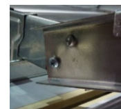
(a) 接合部の損傷
