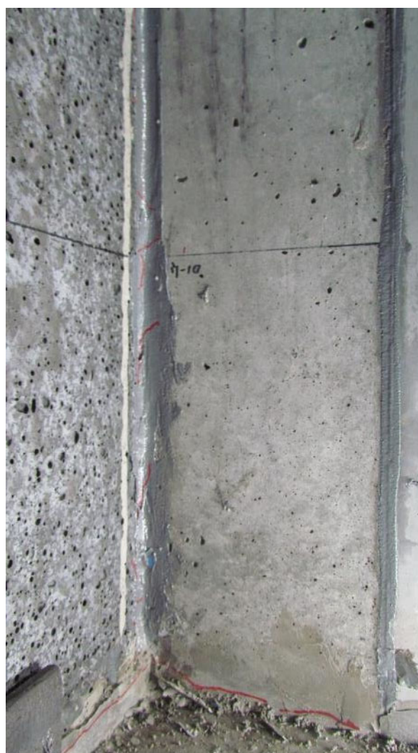
(b) 1/400 時柱、袖壁の境界線のずれ
