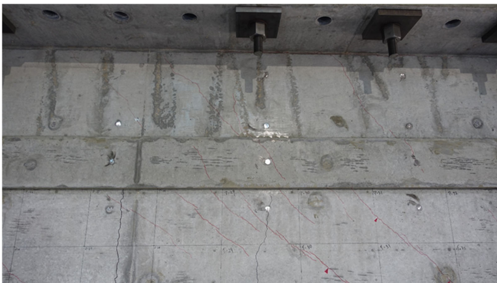
(c) 3階耐震壁ひび割れ
