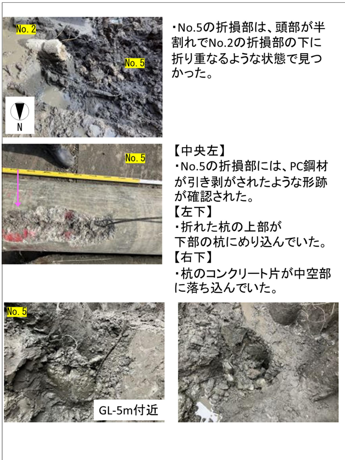
図 3.1.4-19 杭頭部付近の損傷状態 (X2Y3 その2)
