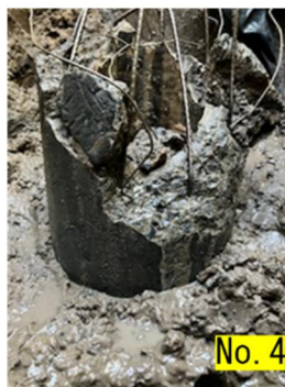
図 3.1.4-7 杭頭部付近の損傷状態 (X0Y0)
