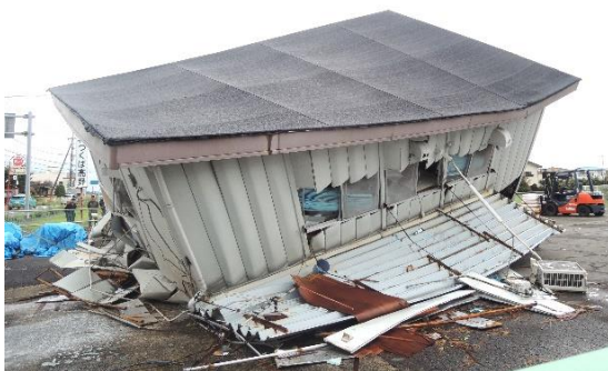
写真 3.1 2階建て建築物の倒壊状況
