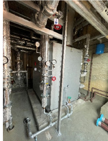
(b) 蒸気ボイラ（損傷無し）
