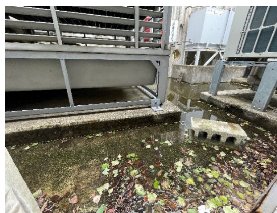
図 4.1.6 冷却塔置場の浸水（建築物 A）
