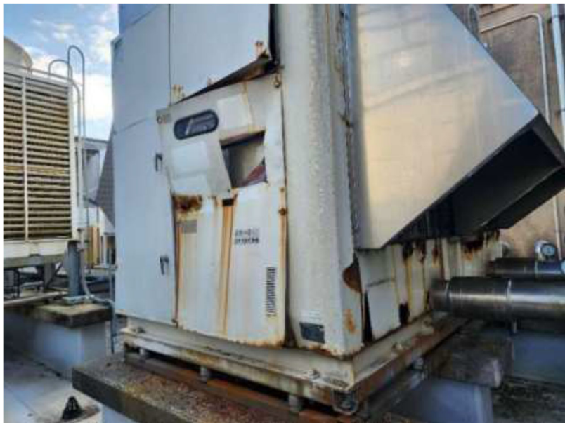
図 4.6.8 破損した冷却器（施設管理者より提供）
