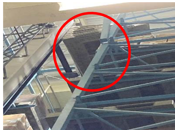
(b) 上部パレットの被害
