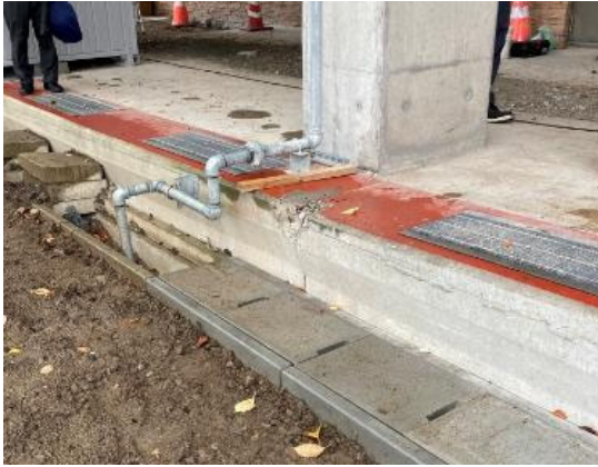
図 4.12.2 地盤沈下で生じた 40 cm の段差
