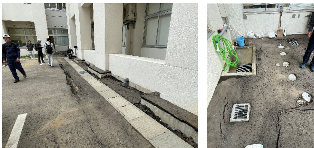
(b) 中庭の地盤沈下の状況
