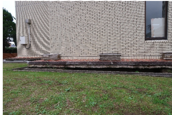
図 4.29.8 建築物 AC 北側の地盤変状
