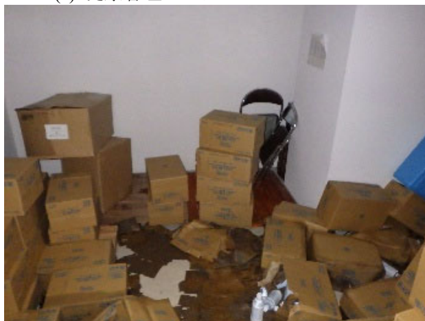
(c) 水浸しになった備蓄品
