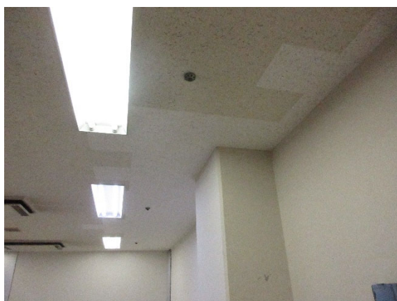
(c) 天井からの漏水跡
