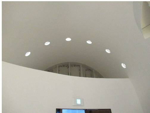
図 4.4.9 企画展示棟 1 排煙窓（建築物 D）
