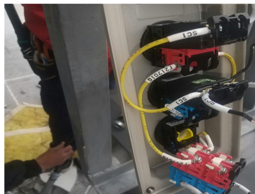
(b) 冷却塔現場操作箱の損傷
