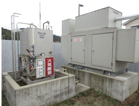
図 4.33.11 自家発電設備
