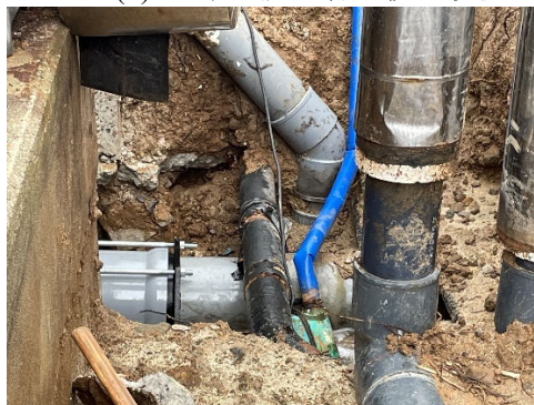
(f) 地中埋設管破断・漏水箇所
