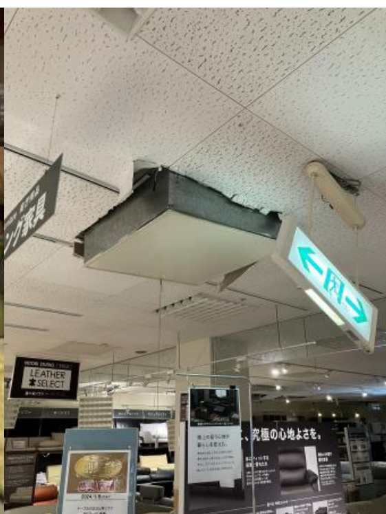
図 4.11.5 排煙口パネルの脱落
