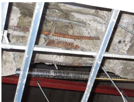
図 4.32.6 屋上階梁の損傷
