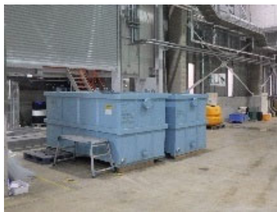
(b) プラント冷却用仮設水槽
