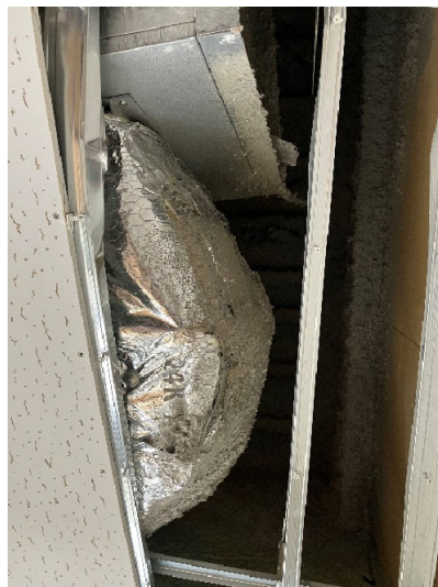
図 4.26.7 外調機の落下（建築物 Z）
