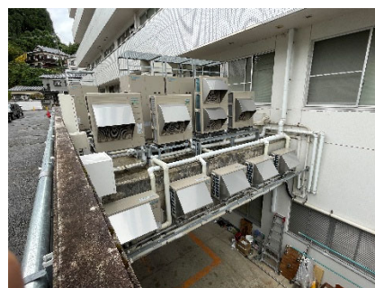
(a) 空調室外機設置状況 1
