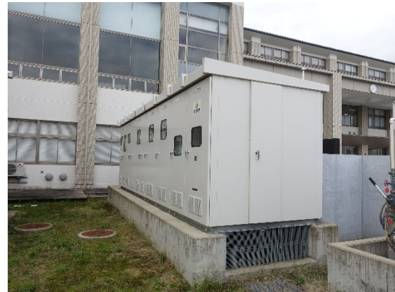
図 4.33.10 屋外キュービクル
