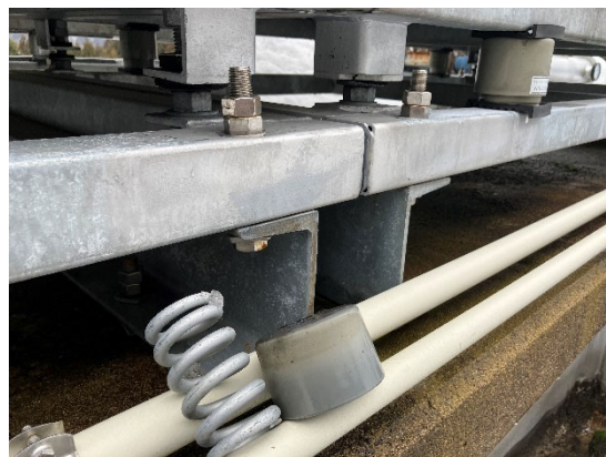
図 4.26.9 防振スプリング脱落
