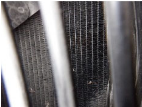
(c) ラジエーター水漏れ
