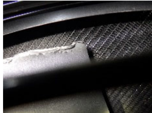
(d) 冷却ファン損傷
