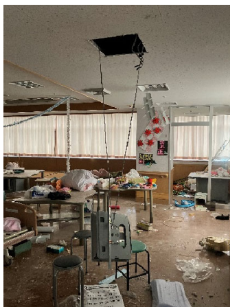
図 4.26.6 照明器具の落下
