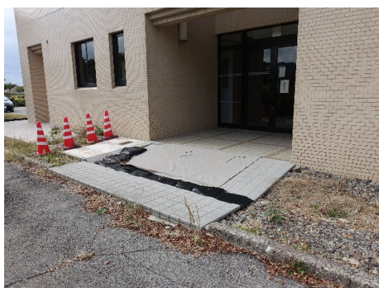
図 4.33.15 外構部の地盤変状
