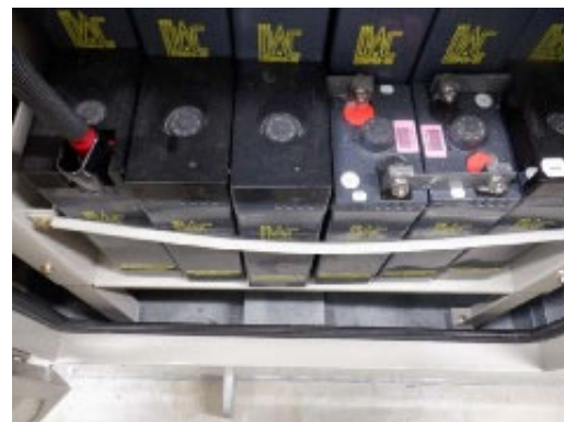
(b) バッテリー損傷
