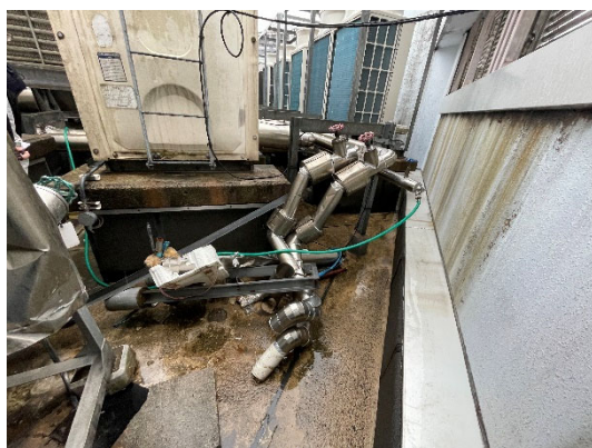
(a) 屋上にて破損した配管
