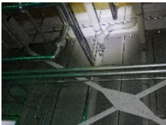
(a) 排水管の損傷状況
