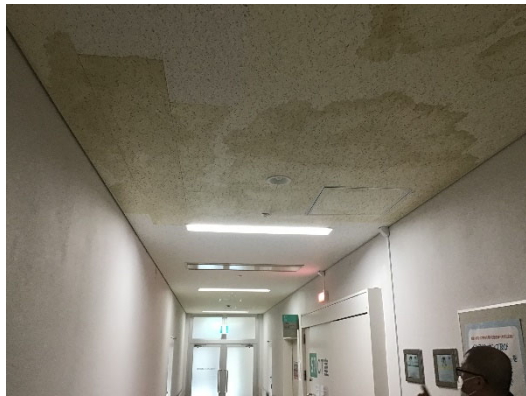
(a) 天井からの漏水跡
