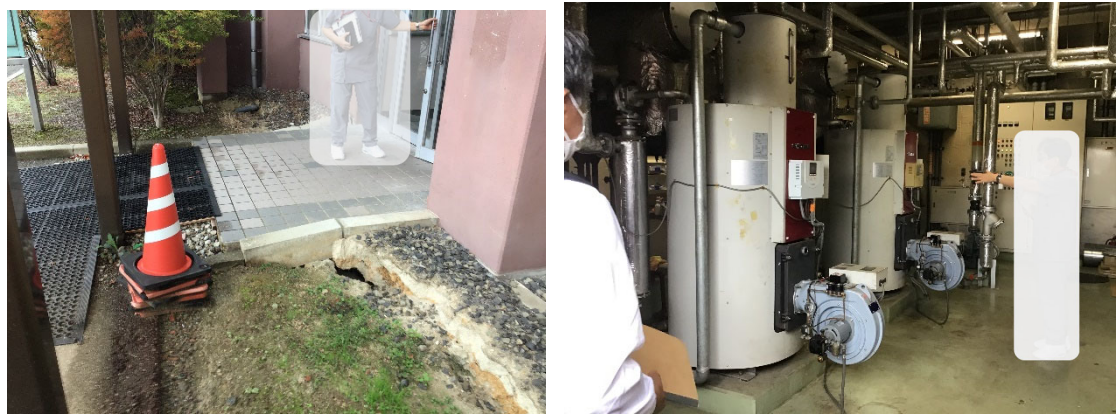
(a) 建築物周囲の地盤沈下状況
