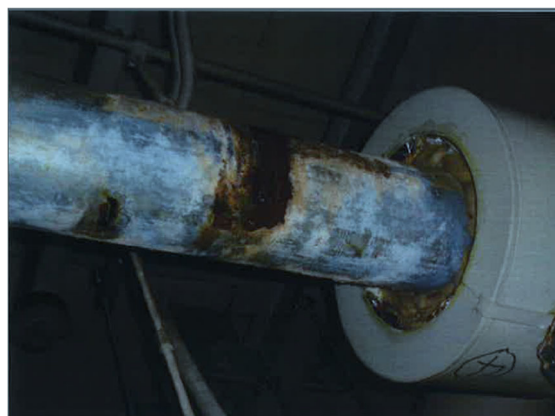
(b) 冷却水配管損傷箇所
