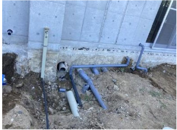
図 4.12.3 排水管の破断・復旧の状況
