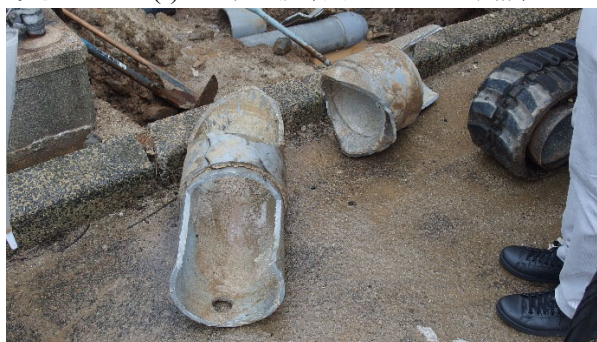
(h) 地中埋設管破断状況
