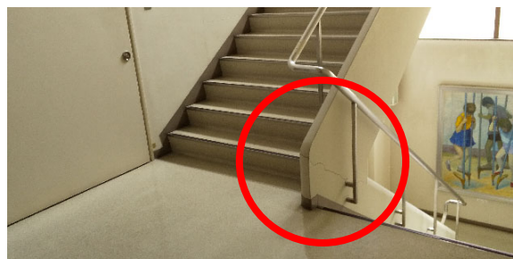
(b) 階段腰壁損傷箇所
