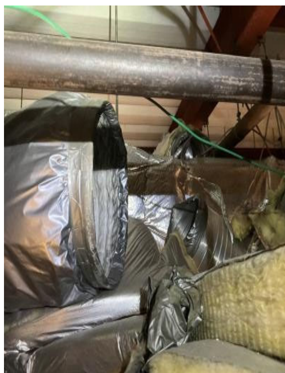
図 4.11.4 ダクトの破断
