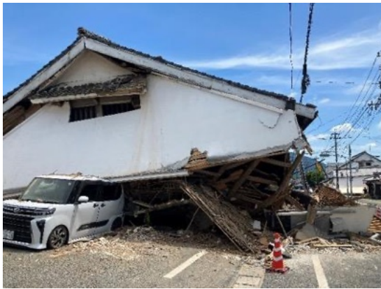
写真 7.2.9 木造住宅の倒壊
