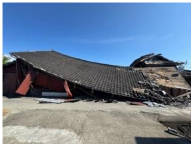
写真 5.2.10a 倒壊した納屋
