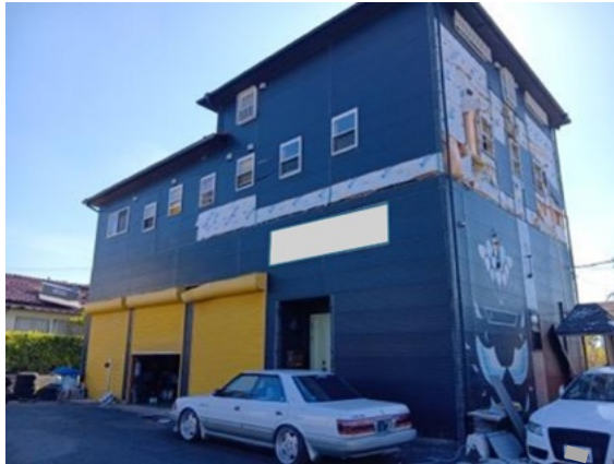
写真 5.2.9a 1 層が鉄骨造、上層が木造の店舗 併用住宅の外壁の剥落
