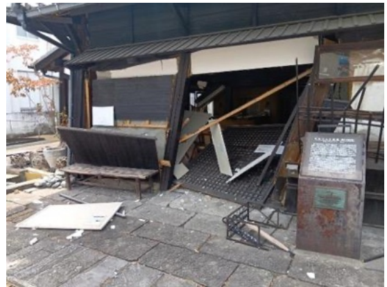
写真 7.2.10 正面開口部の損傷
