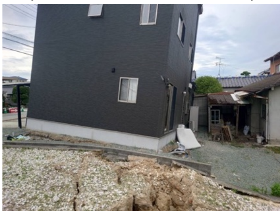
写真 A.3 地盤の変状と建物の傾斜 (国土技術政策総合研究所三木氏提供)
