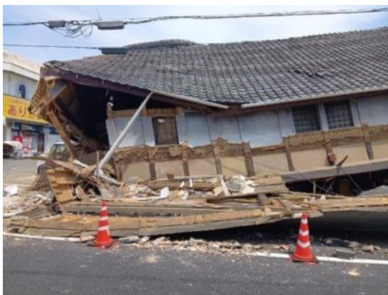
写真 7.2.11 木造住宅の倒壊
