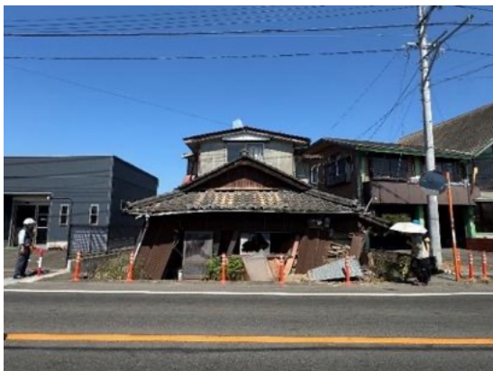
写真 6.2.3a 大きな残留変形のある家屋
