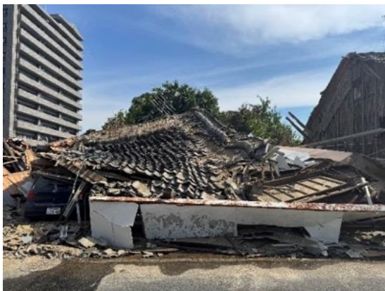
写真 8.2.5 2F 建て住宅の倒壊
