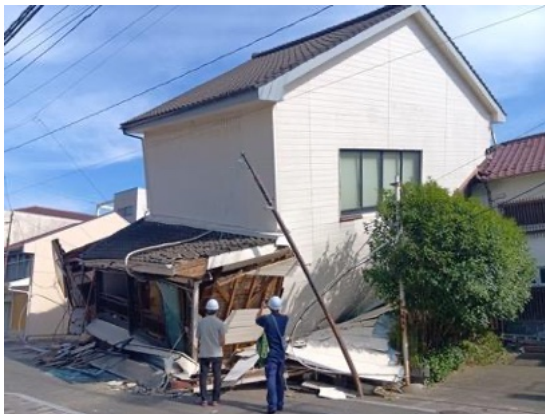
写真 8.2.1 倒壊した 3F 建て木造住宅
