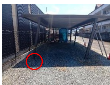
写真 6.2.8a カーポートの変形
