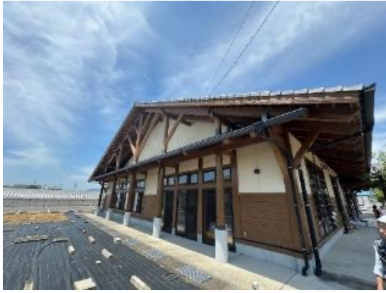
写真 7.2.8 外観上無被害と思われる中規模建築
