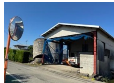
写真 5.2.10f 隣接する外観 上、無被害と思われる鉄骨造 作業場と倒壊した農業用サイ ロ
