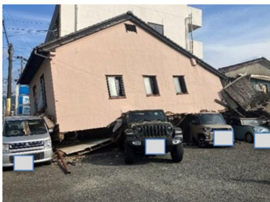
写真 8.2.21 1層の事務所が崩壊した建物
