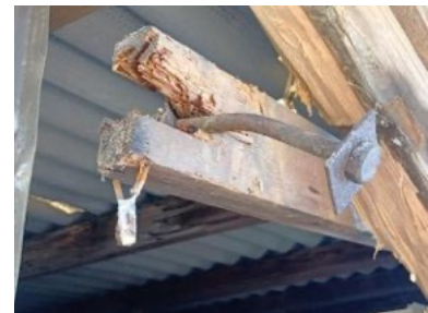
写真 5.2.10c 変形した羽子板 ボルト
