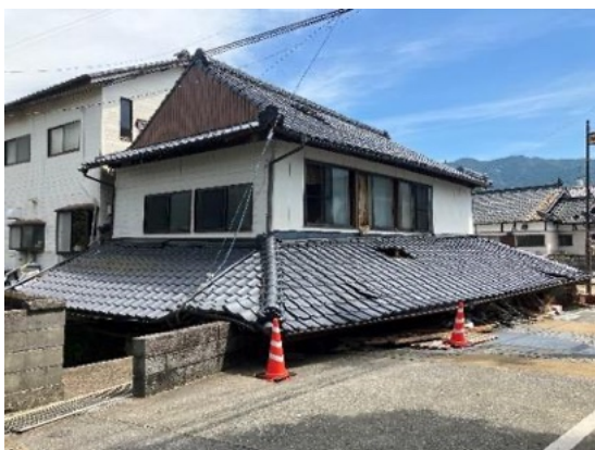
写真 7.2.1 木造住宅の1層崩壊
