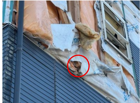
写真 5.2.9b 露出した筋かい端部金物
