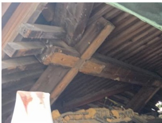
写真 8.2.16 肘木や桁がはずれた様子
