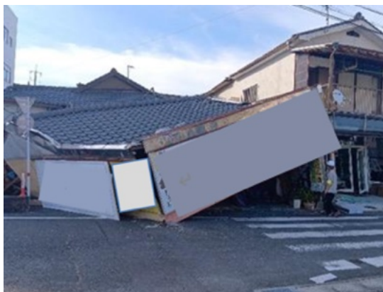
写真 8.2.19 古い店舗の層崩壊
