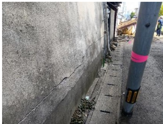
写真 8.2.4 隣接する建物の外壁ひび割れ
