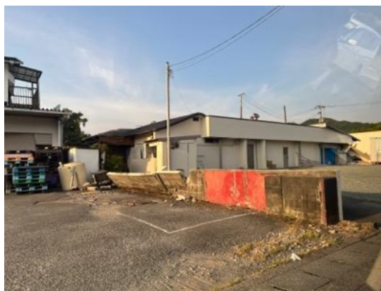
写真 9.2.3 周辺のブロック塀被害
