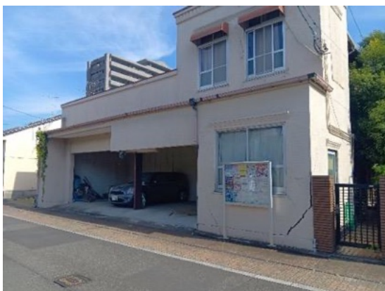
写真 8.2.9 住宅外壁の割れ
