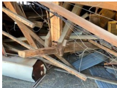
写真 5.2.10b 釘うちのみで接 合された筋かい
