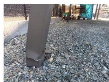
写真 6.2.8b 写真 6.2.8a に○で示した柱の変形
