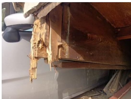
写真 8.2.22 通し柱-大梁の接合部での破断
