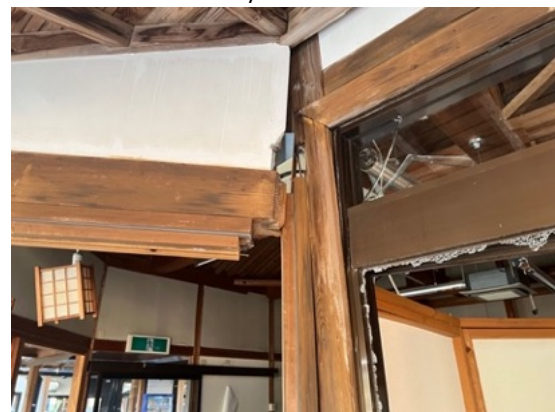
写真 9.2.1d 梁端部の脱落
