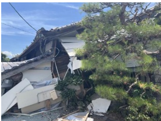
写真 7.2.6b 増築部分の倒壊
