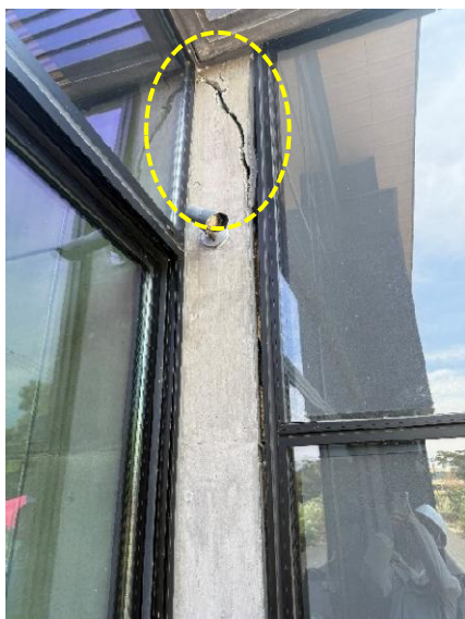
10 図 4.1.1-11 コンクリート製パネルの亀裂
