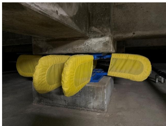
図 4.2.3-5 鋼材ダンパーの残留変形
