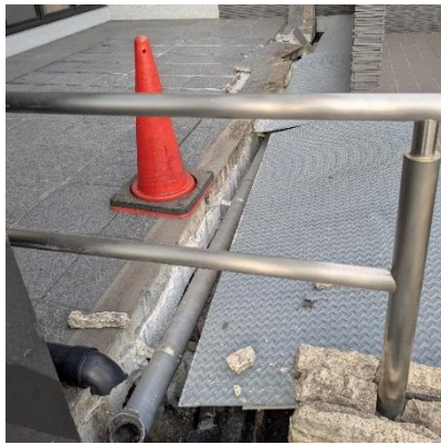
(a) 入口スロープ部カバーの脱落
