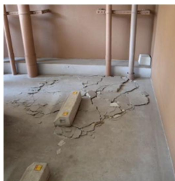
図 4.3.2-1 2016 年の調査における床スラブの被害
