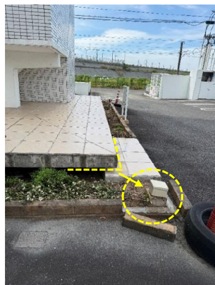
図 4.1.2-6 免震クリアランス内の電灯の破損
