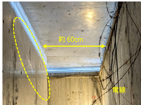
図 4.1.2-2 免震上部基礎と擁壁との接触痕
