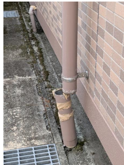
(d) 雨どいの脱落
