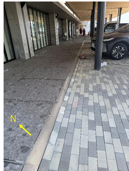
図 4.2.1-7 エキスパンション部の変状
