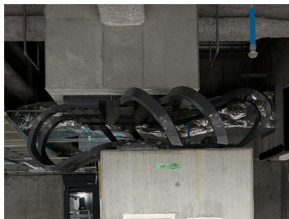
図 4.1.1-5 鋼材ダンパーの変形
