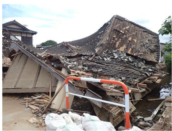
写真 2.3.4 屋根の崩落被害
