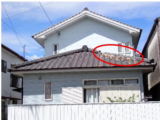
写真 2.2.3 隅棟部分の被害 (住宅 B)
