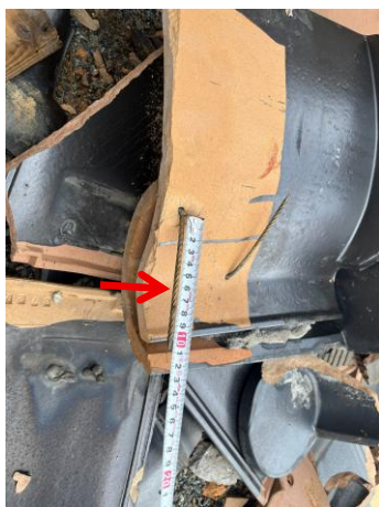
写真 2.4.5 棧瓦を緊結していた釘の状況(寺社 B)
