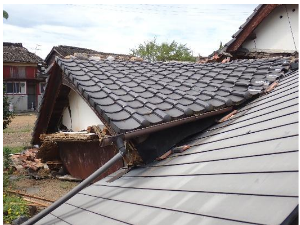
写真 2.3.5 屋根の崩落被害
