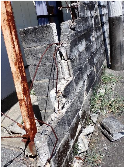
写真 3.1 ブロック塀の倒壊（宇城市松橋町松橋）
