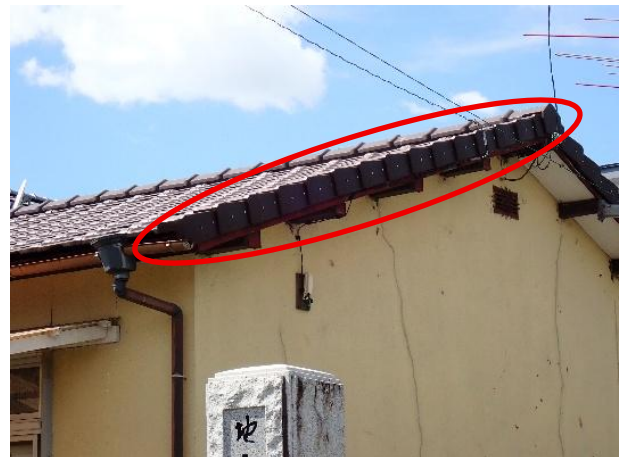
写真 2.2.2 袖瓦の緊結状況（住宅 A）
