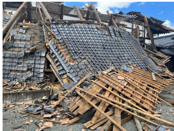
写真 2.4.4 崩落した屋根の状況（寺社 B）
