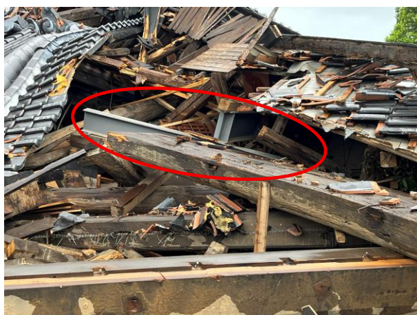
写真 2.4.9 倒壊した小屋組又は軸組の中で確認した H 形鋼（寺社 C）
