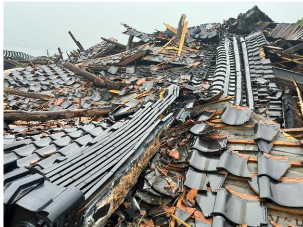
写真 2.4.8 冠瓦とのし瓦が一体となって落下した状況（寺社 C）
