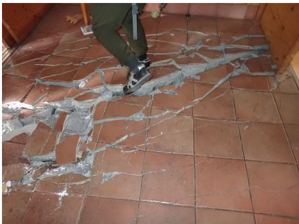
写真 2.1.5 床面の連続した亀裂
