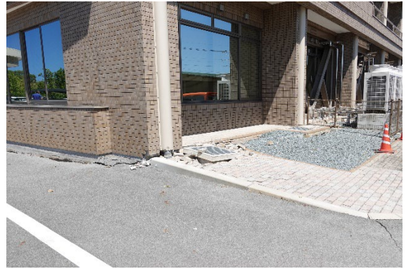
写真 4.26 写真 4.25 の建築物では、基礎周辺地盤の沈下が確認された
