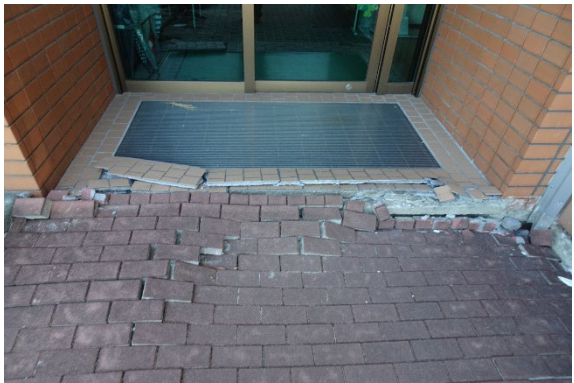
写真 4.23 写真 4.22 の建築物の入口では、基礎周辺地盤の変状を確認
