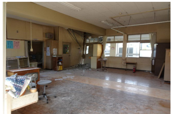
写真 4.30 写真 4.29 の建築物内部では、天井の落下やガラスの破損が確認された
