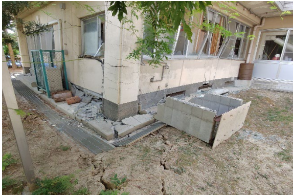
写真 4.31 写真 4.29 の建築物周辺では、基礎部の大きな損傷が確認された
