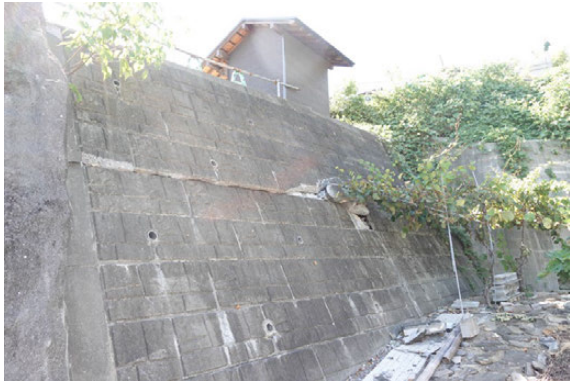
写真 6.3 益城町での擁壁の損傷（横ひび割れ）、 2016 年熊本地震後の擁壁
