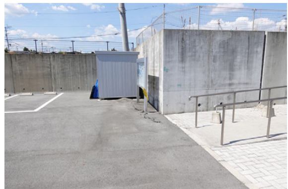
写真 6.8 益城町での擁壁の損傷（縦のすき間 と水平移動）、2016 年熊本地震後の 擁壁
