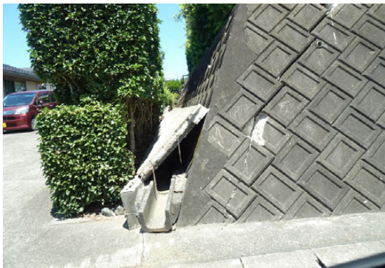
写真 6.1 両仲間団地の擁壁の損傷（横ひび割れ）
