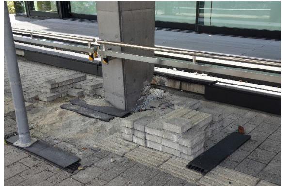
写真 4.4 写真 4.3 の免震建築物では、Exp.J の動きによる底の柱の損傷を確認
