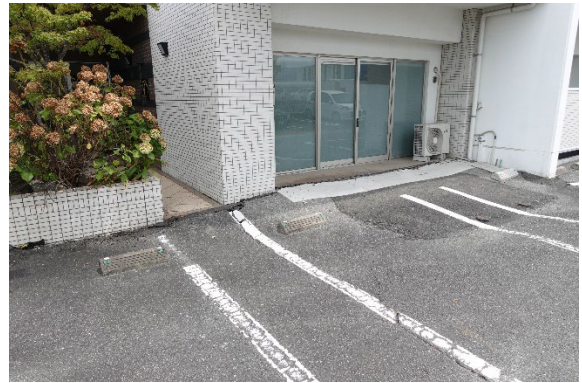
写真 4.10 新八代駅付近の建築物では、抜け上がりと地割れを確認、傾斜無し
