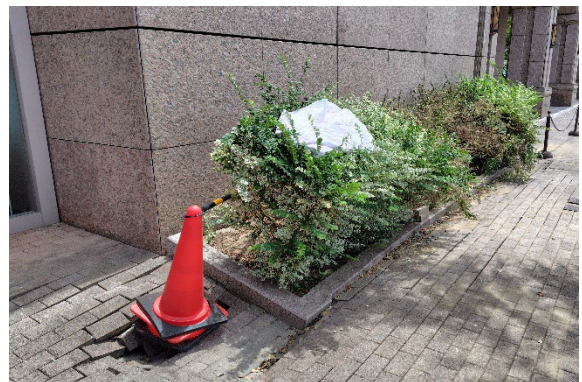
写真 4.6 八代市の公共建築物 2 では、基礎周辺地盤の変状を確認
