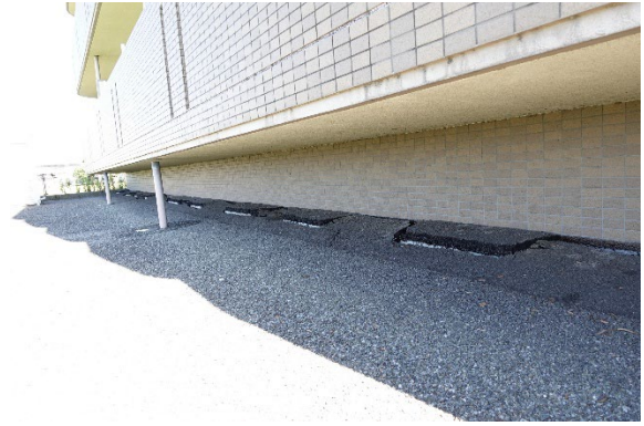
写真 4.14 写真 4.13 の地盤部分では、10cm 程度の基礎抜け上がりを確認
