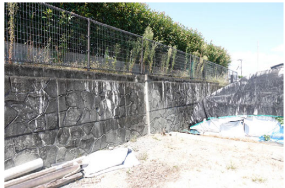
写真 6.2 益城町での擁壁の損傷（縦のすき間と水平移動）
