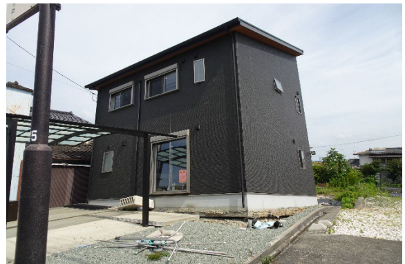
写真 4.28 写真 4.27 の建築物と道路を挟んで反対側では、断層直上の建築物の傾斜が確認された
