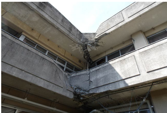
写真 4.29 断層直上に建つ学校建築物では、建築物の大きな損傷が確認された
