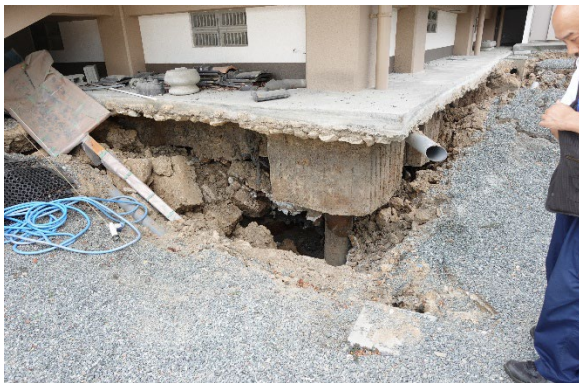
写真 4.27 地表地震断層の出現地点では、杭の露出が確認された
