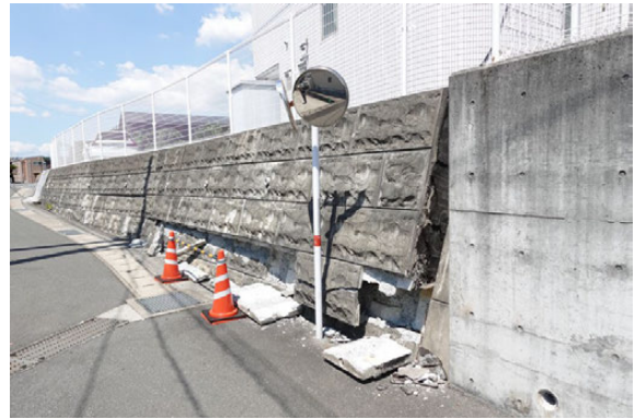
写真 6.6 益城町での擁壁の損傷（横ひび割れ）、 2016 年熊本地震後の擁壁
