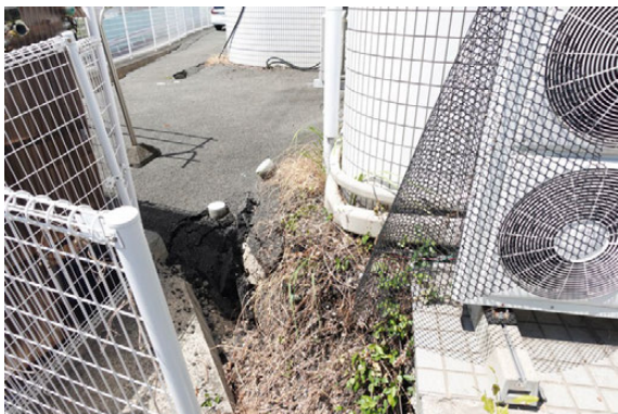
写真 6.7 写真 6.6 の背後地盤、建築物が擁壁 の方向に移動し柵を変形させている
