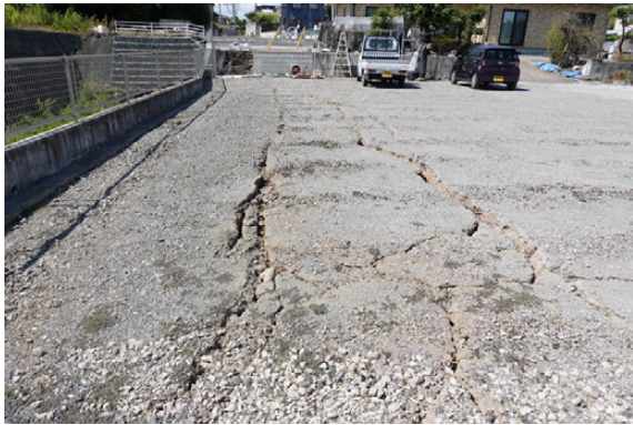
写真 6.5 写真 6.4 の背後地盤、水平移動の方 向と直交方向にひび割れ
