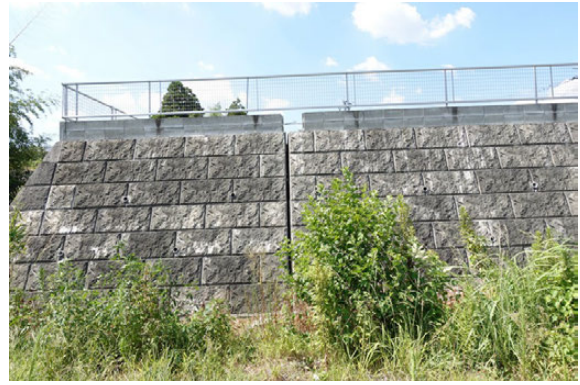
写真 6.4 益城町での擁壁の損傷（縦のすき間 と水平移動）、2016 年熊本地震後の 擁壁
