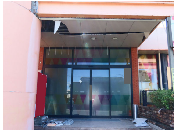
写真 UK-07-b 軒天井の被害状況
