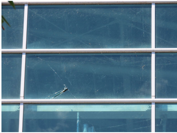
写真 YA-01-g ガラスの被害 ※写真 YA-01-b の D 部
