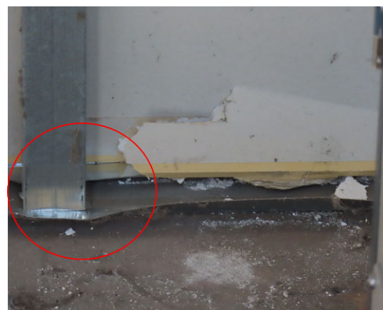
写真 UK-08-d 設備近傍の間仕切壁の 下地の被害
