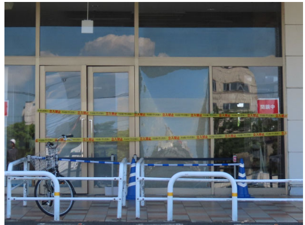
写真 YA-03-d 北側の扉の傾き
