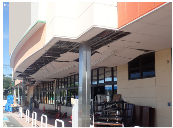
写真 UK-03-b 軒天井の天板の脱落
