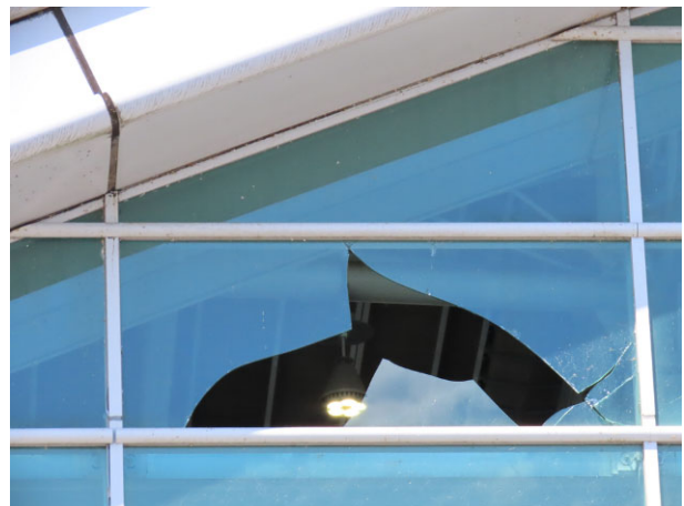
写真 YA-01-f ガラスの被害 ※写真 YA-01-b の C 部
