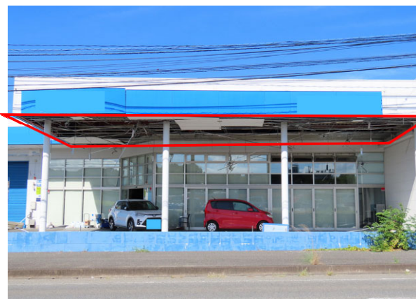
写真 UK-04-a 軒天井の被害状況
