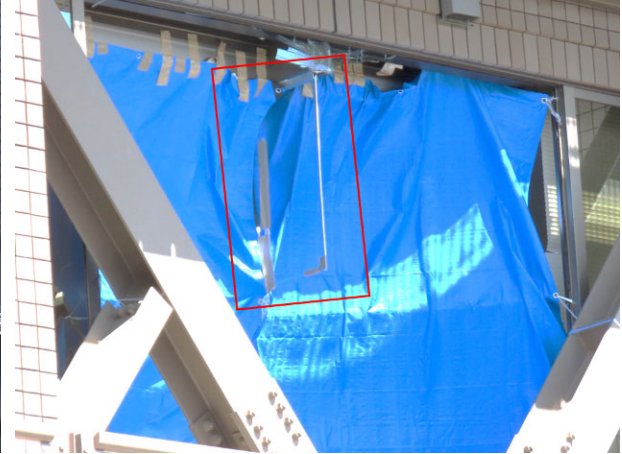
写真 UK-05-b 防煙垂れ壁と思われる部材が外に出ている様子
