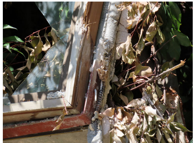
写真 UK-09-d 脱落した窓
