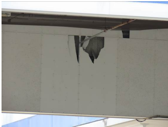
写真 UT-01-c 垂れ壁の内装材の脱落
