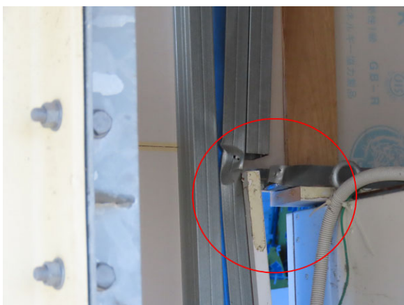
写真 UK-08-c 設備近傍の間仕切壁の 下地の被害
