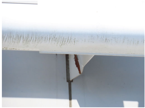
写真 YA-01-h 鉄骨部材の変形 ※写真 YA-01-b の E 部
