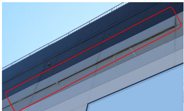
写真 YA-04-b ALC パネルの被害状況
