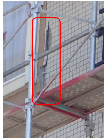
写真 YA-02-b 外壁パネルの被害状況
