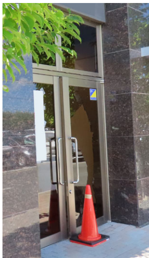
写真 UK-05-c 別棟のガラス被害
