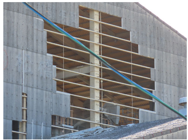
写真 UK-01-b 外装材の被害状況
