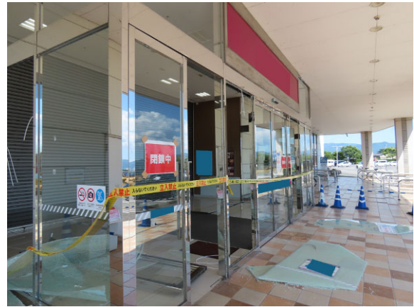
写真 YA-03-b 南側のエントランスの被害状況
