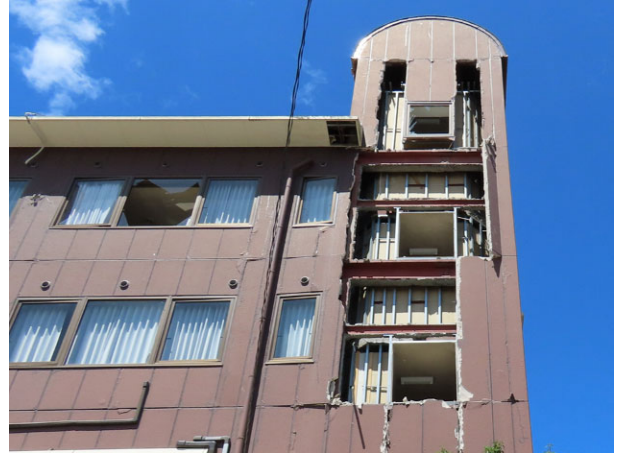
写真 UK-09-b 東面の被害状況
