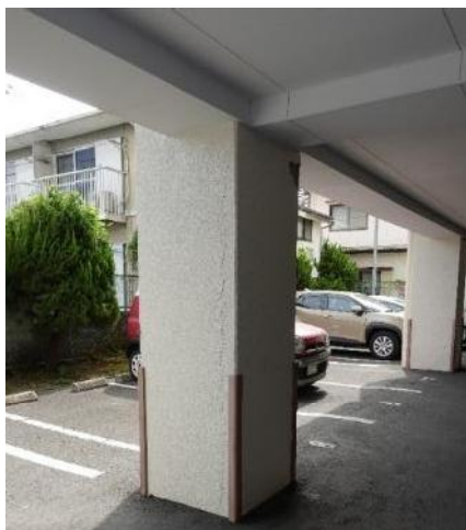
写真 3.2.24-3 柱の付着割裂ひび割れ
