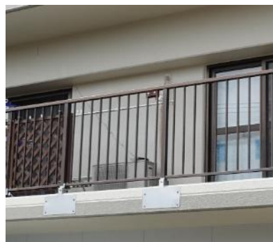
写真 3.2.24-2 方立壁のせん断ひび割れ
