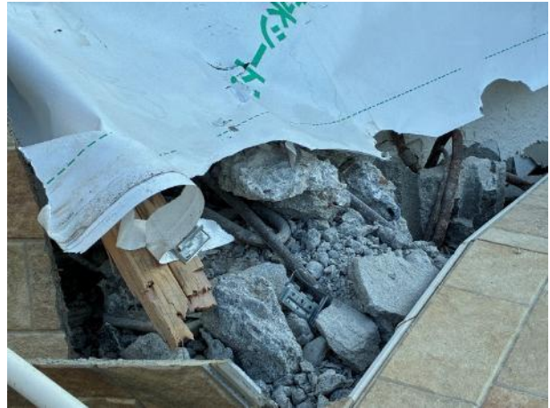
写真 3.2.2-2 崩れた柱の一部
