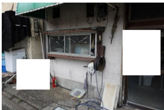
写真 3.2.47-3 窓開口周りの非構造壁のひび割れ
