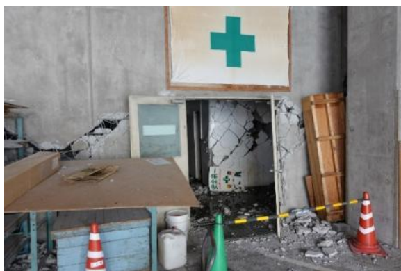
写真 3.2.3-8 建築物 Y-6 の壁のせん断破壊
