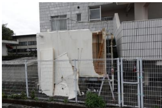
写真 3.2.25-5 FRP 製水槽の損傷
