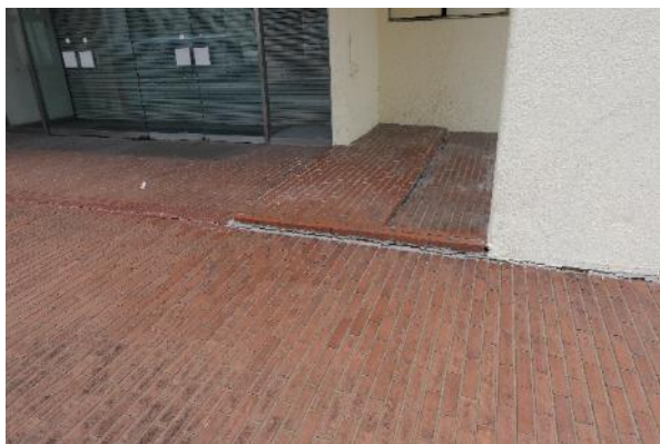
写真 3.2.7-3 入口周辺の被害
