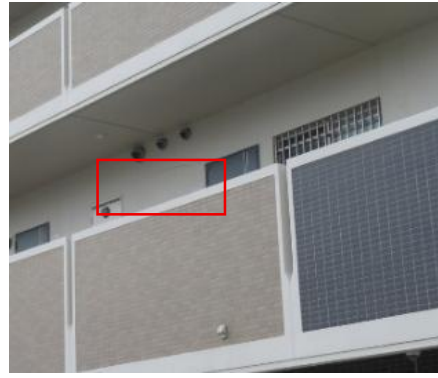
写真 3.4.10-4 廊下側の非構造壁の曲げひび割れ (写真内の赤囲位置)
