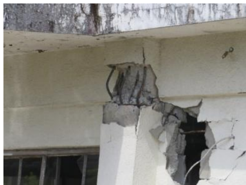
写真 3.4.5-4 1 階柱頭の損傷
