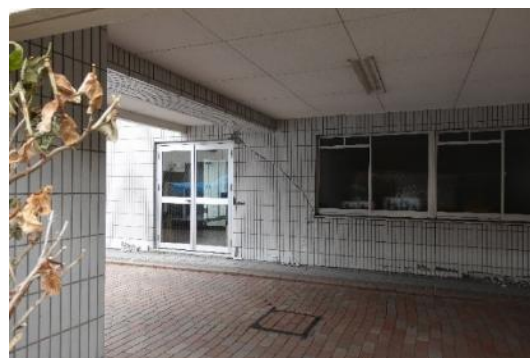
写真 3.2.25-4 非構造壁のせん断ひび割れ
