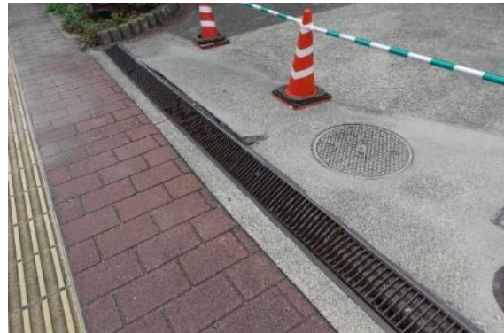
写真 3.2.41-2 周辺地盤の変状
