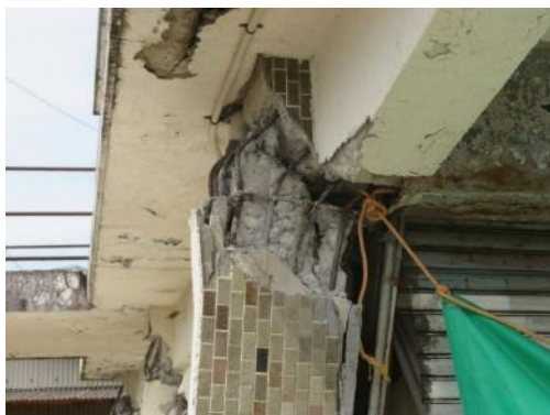
写真 3.4.5-3 1 階柱頭の損傷
