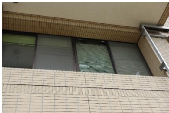
写真 3.2.5-8 窓の割れ（柵の転倒による）
