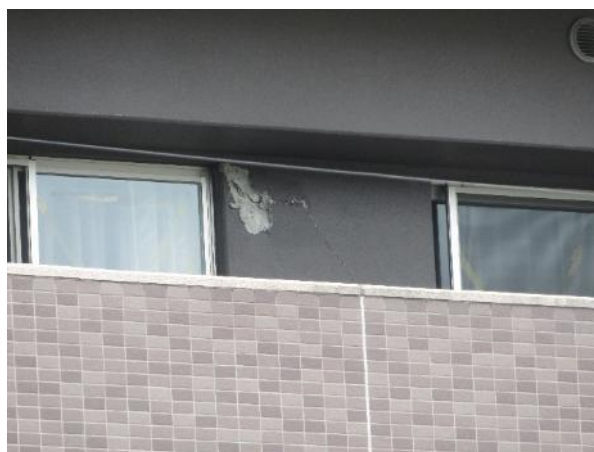
写真 3.2.27-2 方立壁のせん断ひび割れ等の被害
