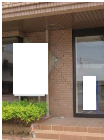
写真 3.4.6-2 1 階の非構造壁のせん断ひび割れ
