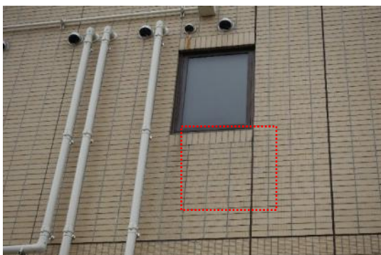
写真 3.2.5-7 窓下壁のせん断ひび割れ
