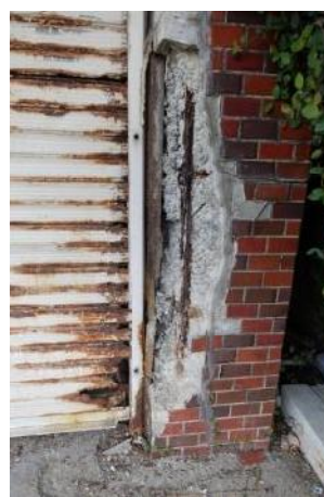
写真 3.2.47-2 柱のカバーコンクリートの剥落
