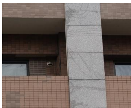
写真 3.2.18-2 柱のタイルの剥落
