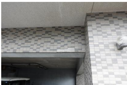
写真 3.2.28-3 梁の曲げひび割れ及び タイルの剥落
