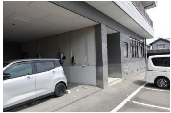
写真 3.4.2-8 会議棟における非構造壁の損傷
