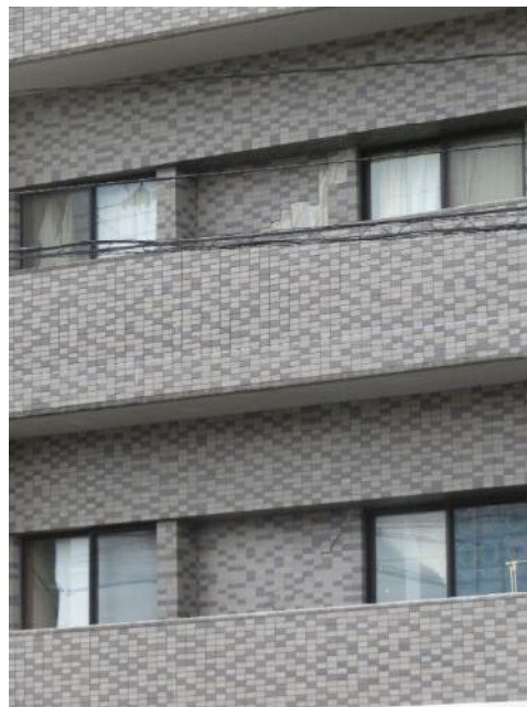
写真 3.2.28-2 非構造壁のせん断ひび割れ
