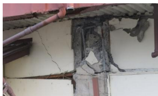
写真 3.2.6-3 2階柱梁接合部の損傷状況
