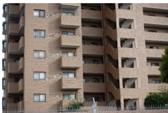
写真 3.2.31-3 非構造壁の被害状況
