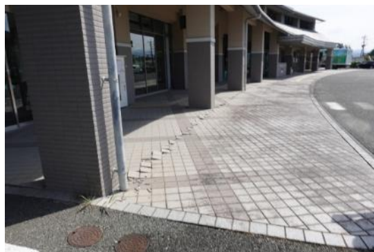
写真 3.4.3-4 周辺の地盤変状
