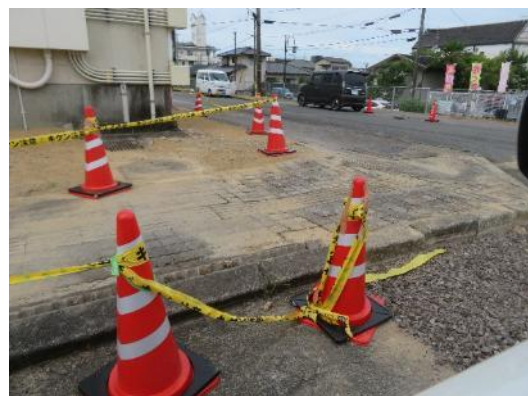
写真 3.4.8-2 周辺の地盤変状
