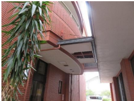
写真 3.2.4-2 天井仕上の落下
