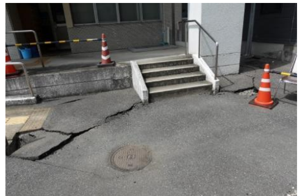
写真 3.4.2-10 エレベータホール周辺の地盤変状
