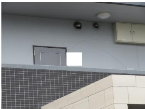
写真 3.3.4-3 非構造壁のせん断ひび割れ
