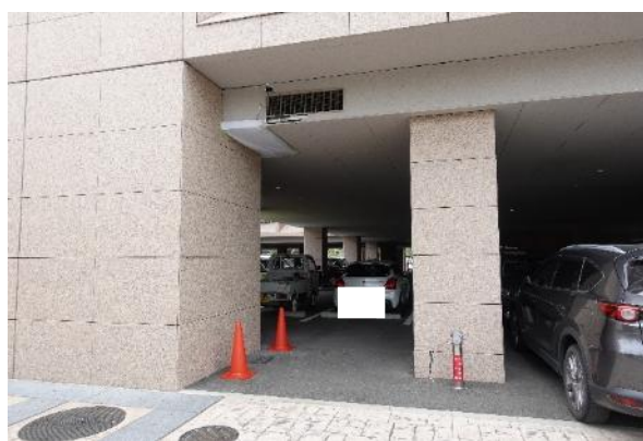
写真 3.2.8-2 石張りの割れ
