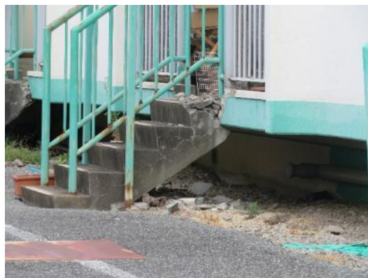
写真 3.4.7-2 入口階段付け根の被害
