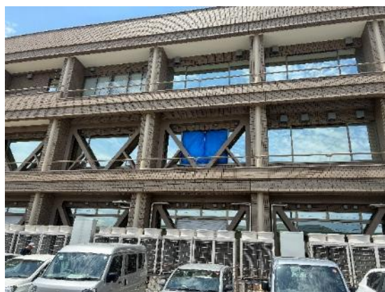
写真 3.4.1-2 窓ガラスの破損
