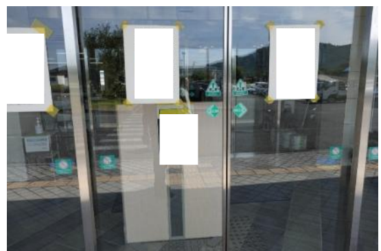
写真 3.4.3-2 自動ドアの故障
