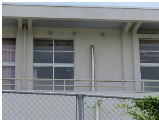
写真 3.4.4-2 2 階非構造壁の せん断ひび割れ（UK-4）
