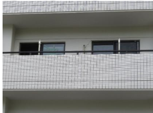
写真 3.2.20-2 方立壁のせん断ひび割れ
