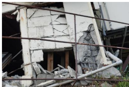
写真 3.2.6-2 1階柱脚の損傷状況
