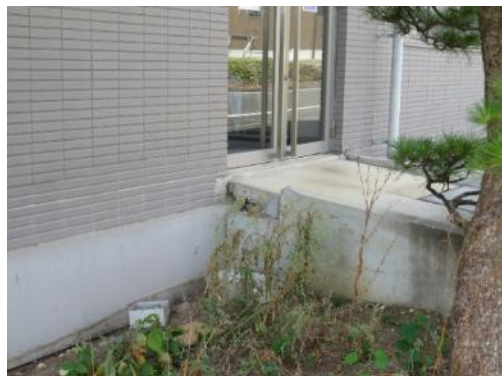
写真 3.4.3-5 周辺の地盤変状
