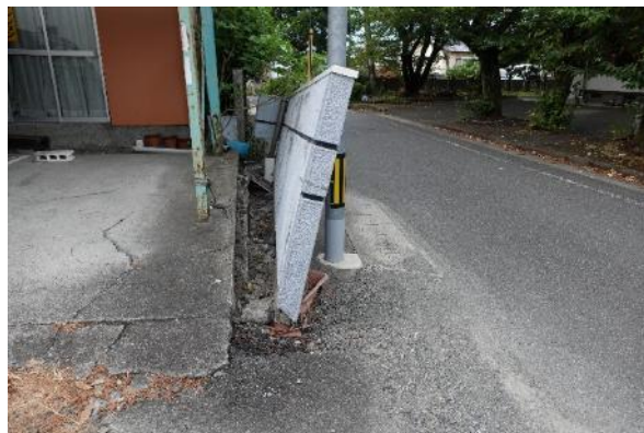
写真 3.2.32-4 周辺のブロック塀の被害
