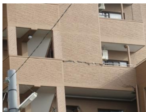
写真 3.2.31-4 非構造壁の被害状況
