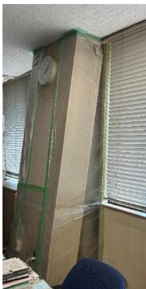
写真 3.1.2-1 鉄骨柱の内装材の被害
