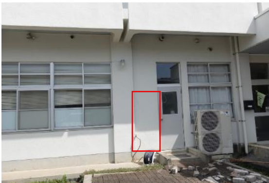
写真 3.4.4-5 1 階非構造壁の せん断ひび割れ（写真の赤囲位置）（UK-5）
