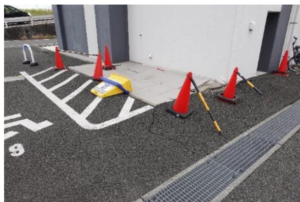
写真 3.2.40-2 建築物周辺地盤の変状
