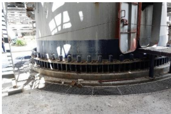
写真 3.2.3-9 建築物 Y-6 に付随する製造設備 のアンカーボルトが伸びている状況
