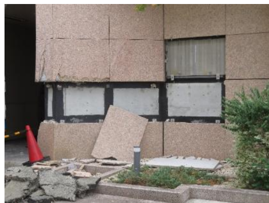
写真 3.2.8-4 石張りの落下②
