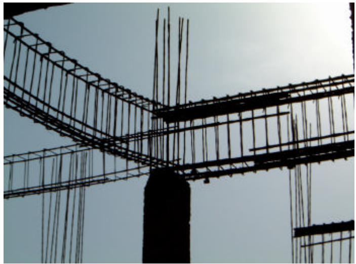
写真 1 2 Bhuj 市の施工現場での配筋状況 梁配筋が柱梁接合部に十分に定着されていない。
