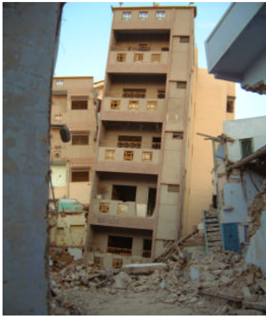
写真 1 1 Bhuj 旧市街地での R C 造建物の被害 大きく傾斜している。ピロティかは不明
