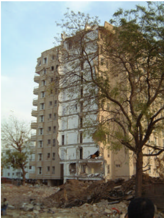
写真 3 建物の手前部分が完全に崩壊した集合住宅 (1 階がピロティ形式)
