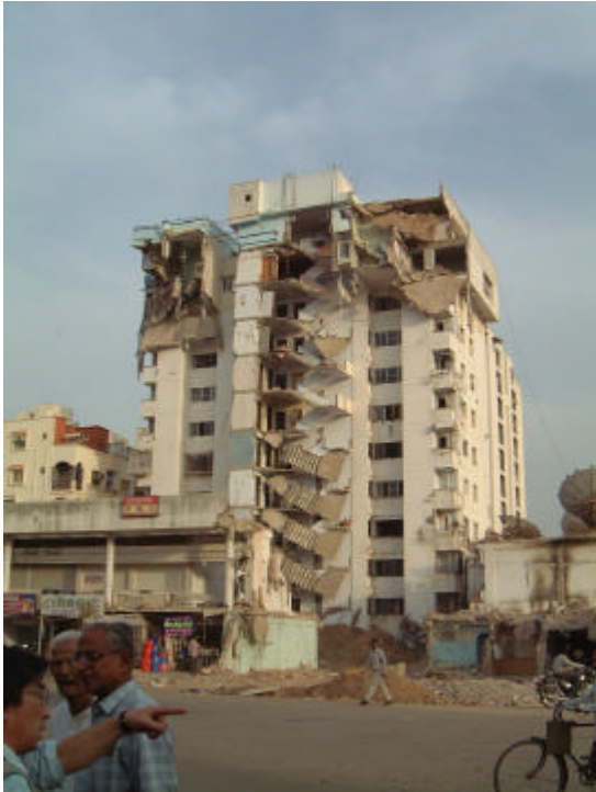
写真 1 建物の手前部分が完全に崩壊した集合住宅 (1 階がピロティ形式)
