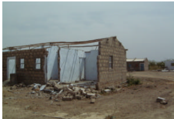
写真8 比較的新しい組積造の被害 壁が面外方向に倒れている。
