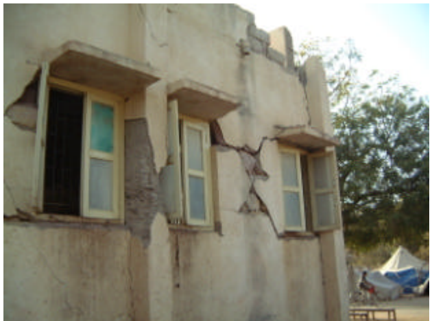
写真10 Anjar の病院の被害 柱はRC造、壁は組積造
