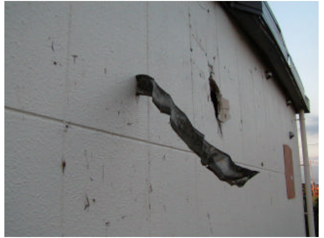
写真 20 消防センター壁面(南からみる) ALC パネルの壁材に飛散物が突き刺さっている。
