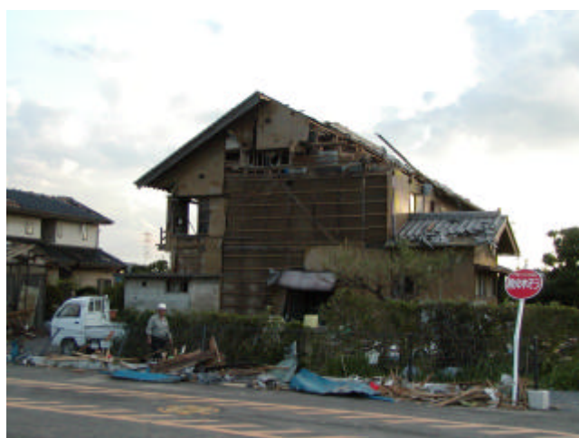
写真 17 住宅 D 外観(東からみる) 東側妻面及び軒部の外装材の飛散。
