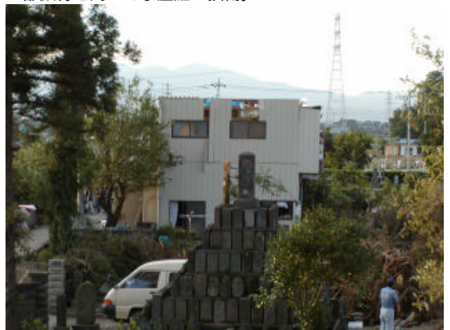
写真6 住宅A外観(南からみる) 南面壁面の損傷。2 階南面の窓ガラスは破損しておらず、1 階も右側の窓ガラスが破損しただけであった。この住宅は 2 棟続いて屋根が吹き飛ばされ、出口に駐車していた自家用車が北に約 10m 突風により移動した。
