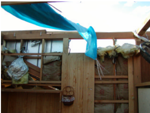
写真5 住宅A室内(南からみる) 在来軸組工法による住宅の小屋組が飛散。
