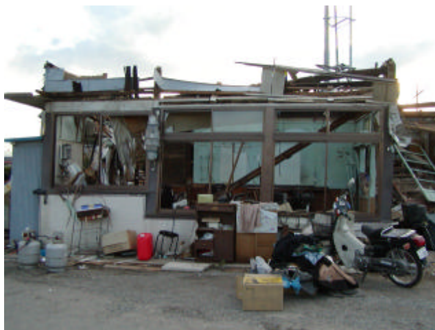
写真 14 住宅 B 外観(東からみる) 在来軸組工法による住宅の小屋組が飛散。
