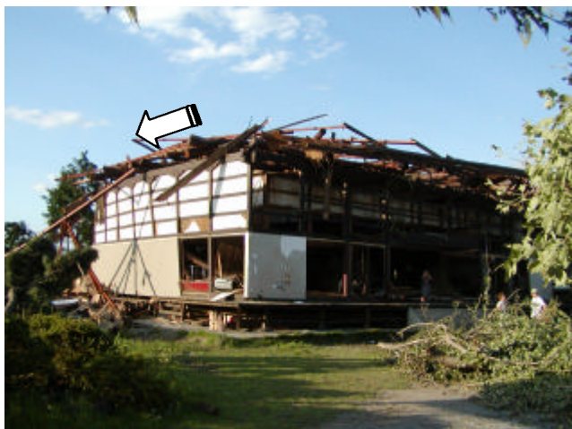
写真7 天人寺外觀(南西からみる) 小屋組の崩壊及び外装材の飛散。柱が北側へ傾斜。
