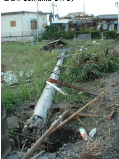
写真11 電柱の転倒(南からみる)
