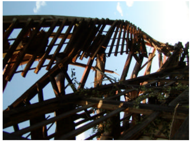
写真4 天人寺 一部鉄骨を用いた小屋組の損傷。
