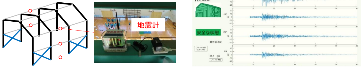
写真 I-1. 2. 3 つくば市内の体育館への地震計設置と耐震安全性判定表示システム(PC)の画面
