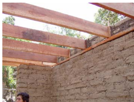
写真9 屋根梁 対面する壁のリング・ビームを繋ぐ形で60cm 間隔で設置される屋根梁（断面 5x20cm）。
