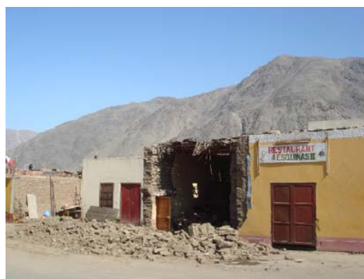
写真3 被災したアドベ住宅の状況
