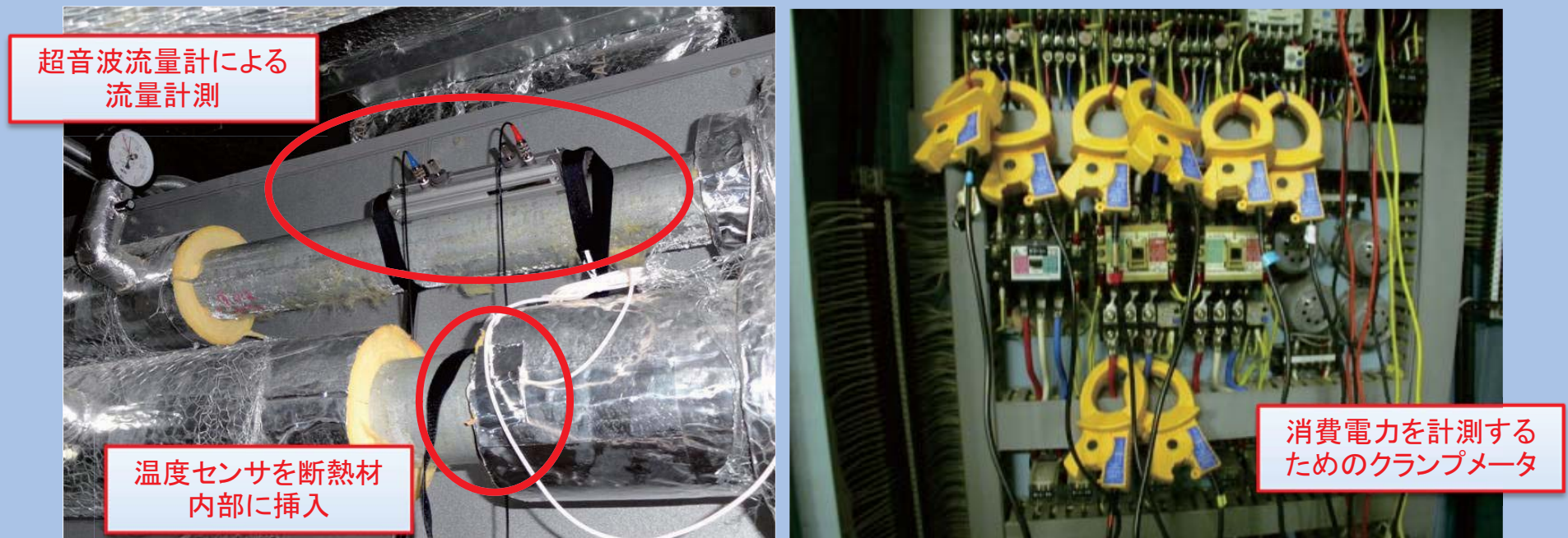
図6 計測の様子（殆ど建物では、BEMSと呼ばれる運転管理システムによって取得されたデータを利用した。一部の建物で写真のように追加で計器を設置して運転データを計測）
