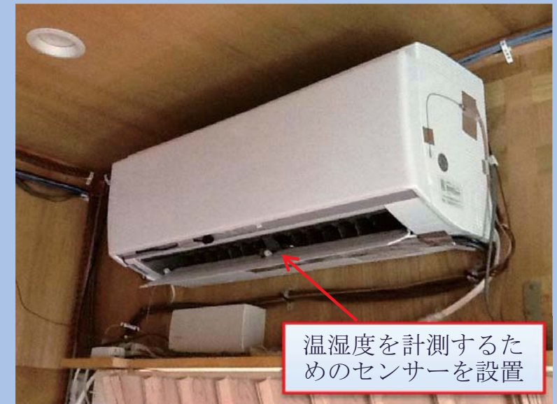
図2 実測対象エアコン
