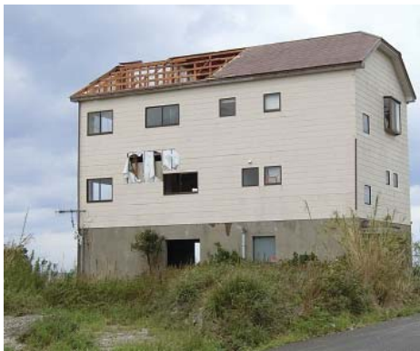
屋根の飛散と外壁の破損
