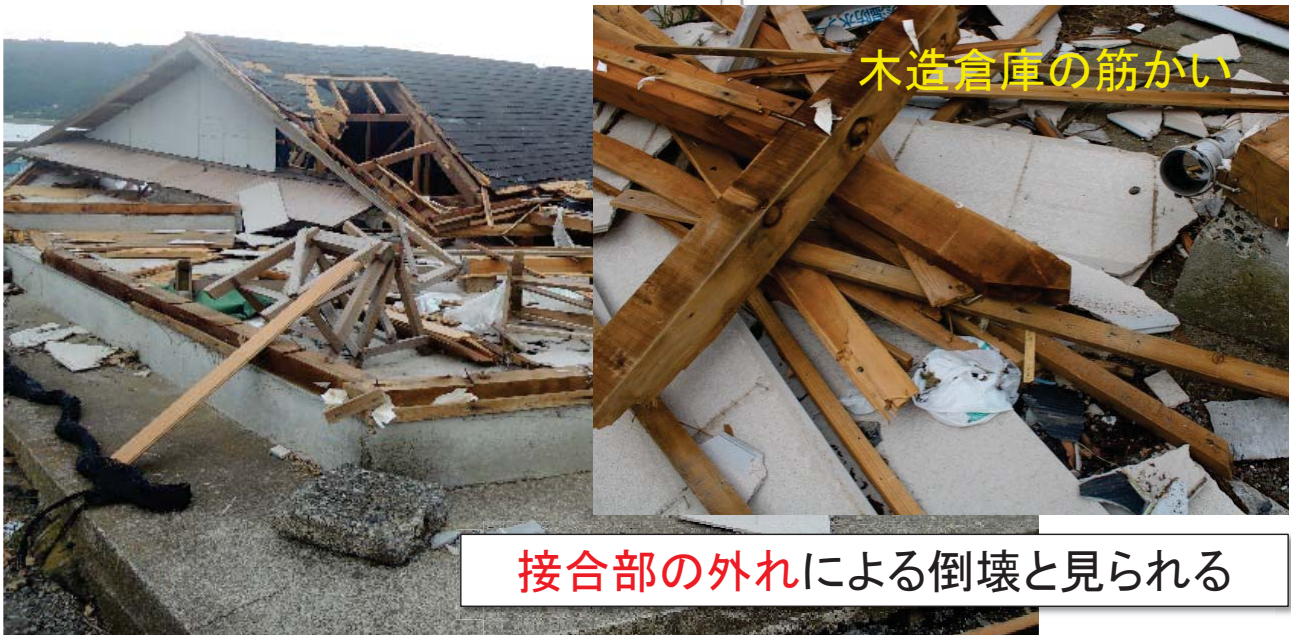
海沿いの木造倉庫の倒壊
