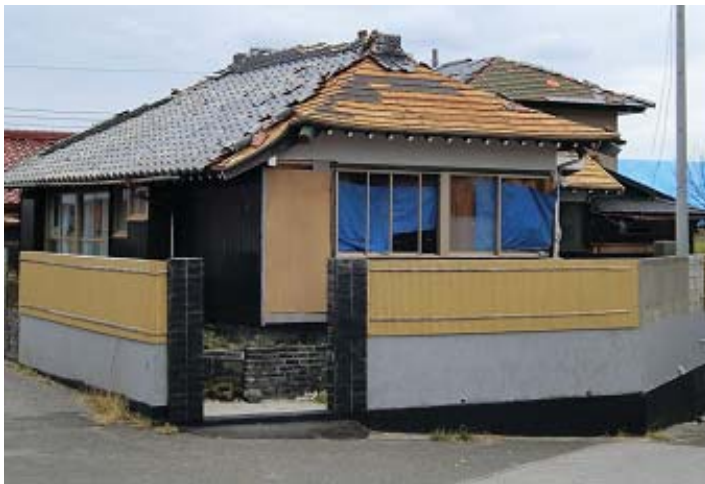
寄棟屋根の一面の瓦が全面的に落下
