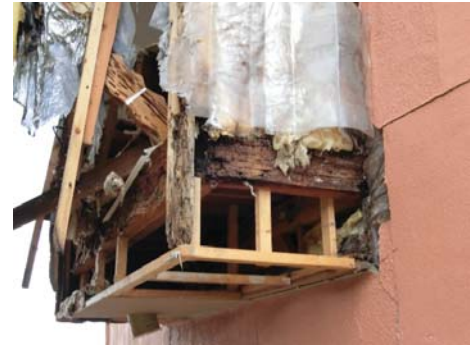
躯体に生じた著しい腐朽・蟻害
