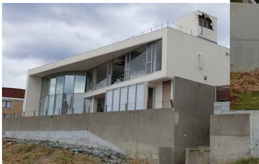
窓ガラスの破損
