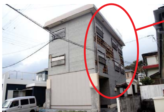
鉄骨造住宅の外壁材の飛散
