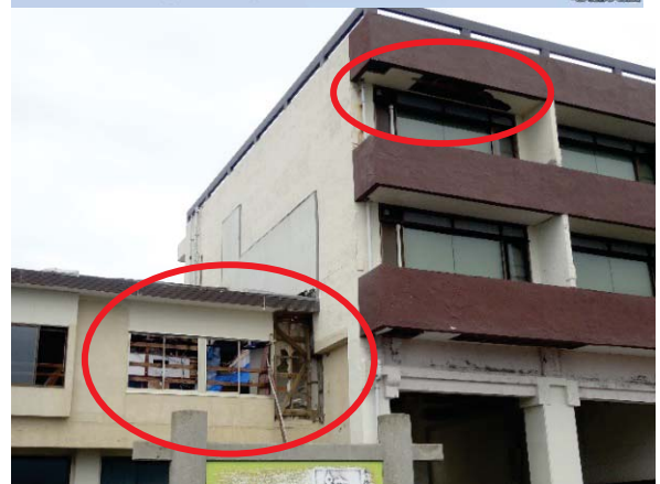
外壁と軒天井の被害状況
