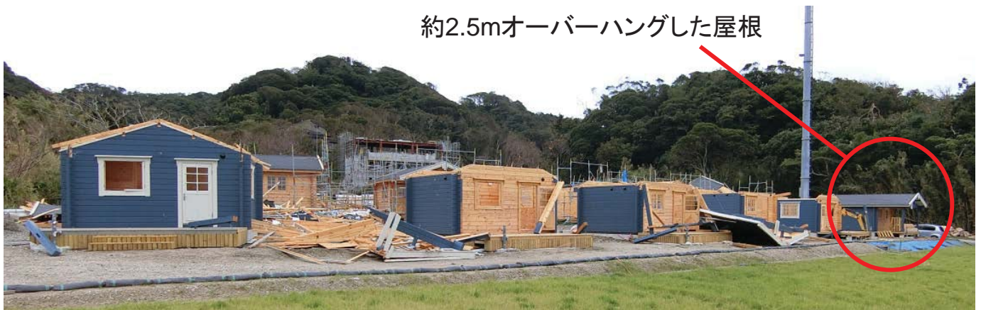
建設途中の12棟のログハウスの被害状況
