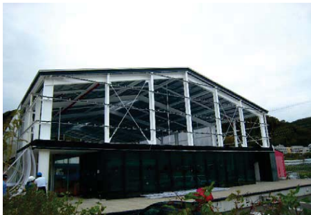
全ての外装材が飛散した妻面
