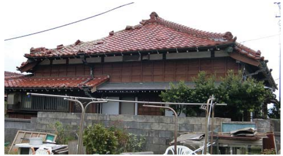
寄棟の偶棟部の瓦の落下
