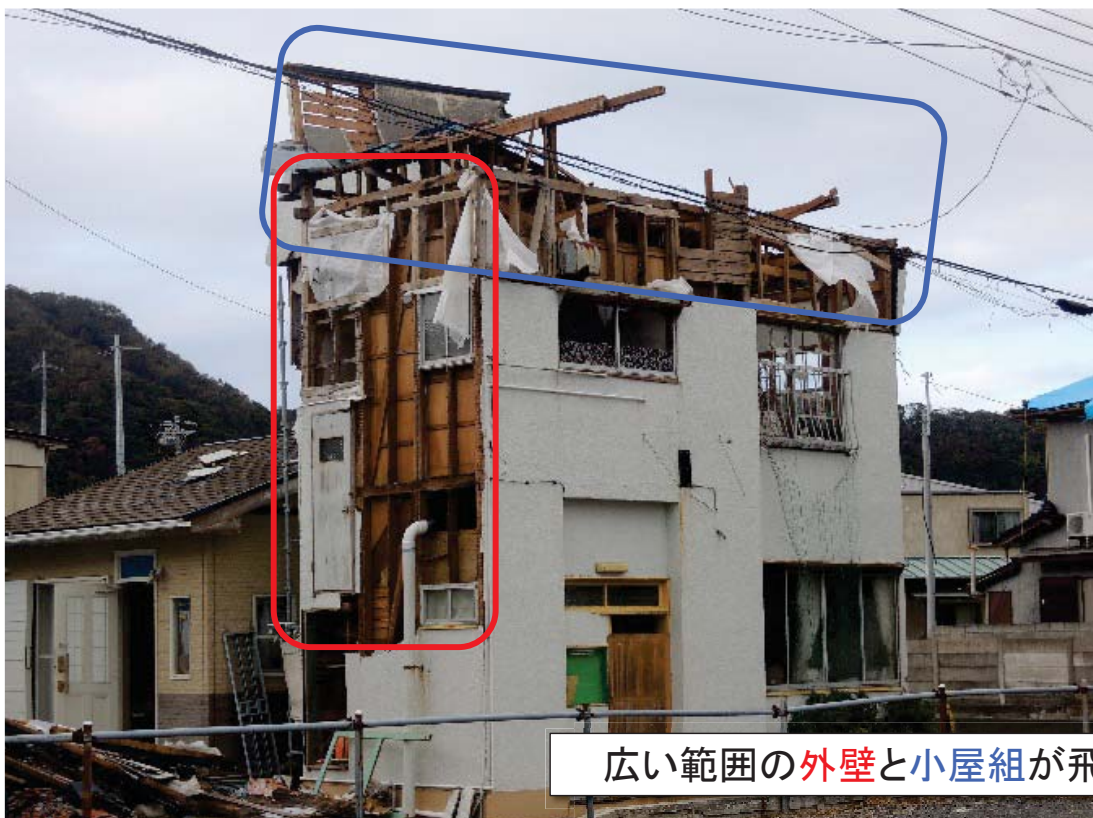
築年数が比較的経過している木造住宅の被害状況
