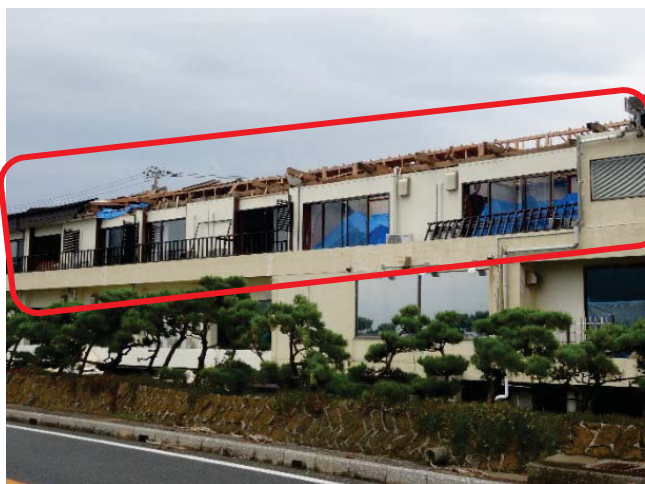
屋根とベランダの被害状況
