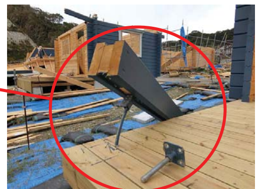
柱脚の被害状況
