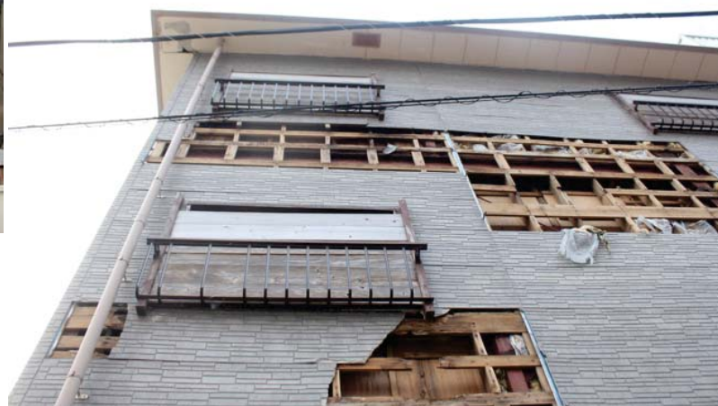
住宅の外壁材の被害
