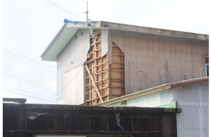
店舗兼住宅の外壁材の被害
