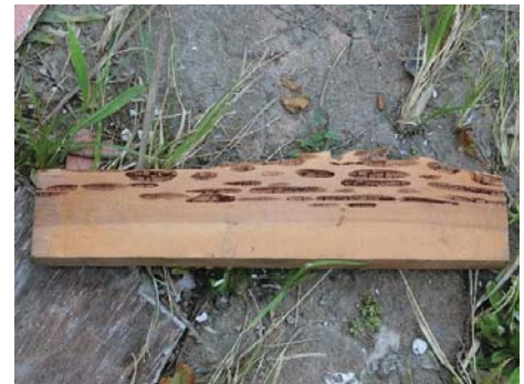
住宅の蟻害を受けた部材
