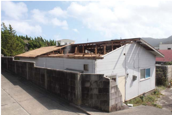
住宅の屋根被害
