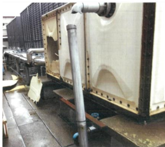
図1 医療施設の屋上に設置された高置タンクの被害(相馬市) (建築物担当者による提供写真)
