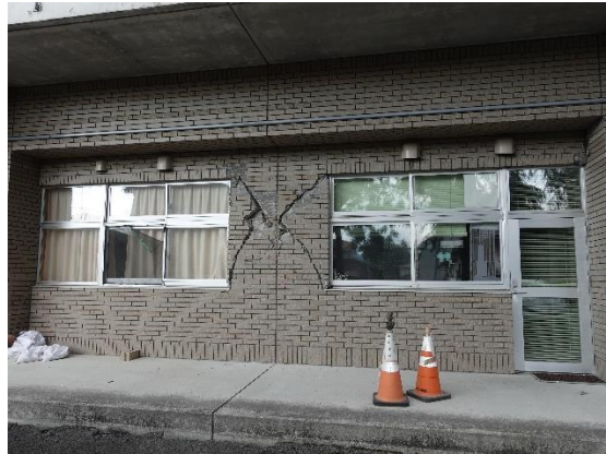
図2 非構造壁の被害
