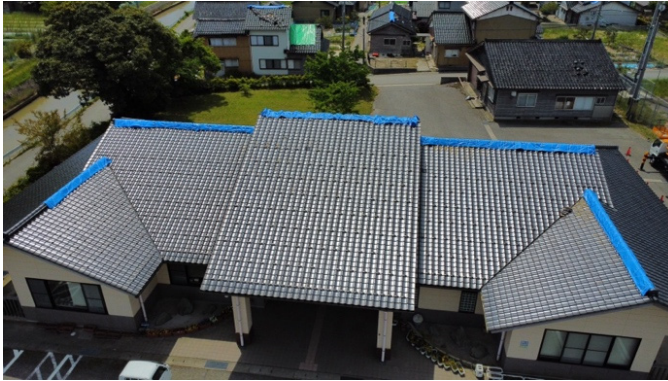
写真2-1 瓦屋根の被害（棟部のみ被害）
