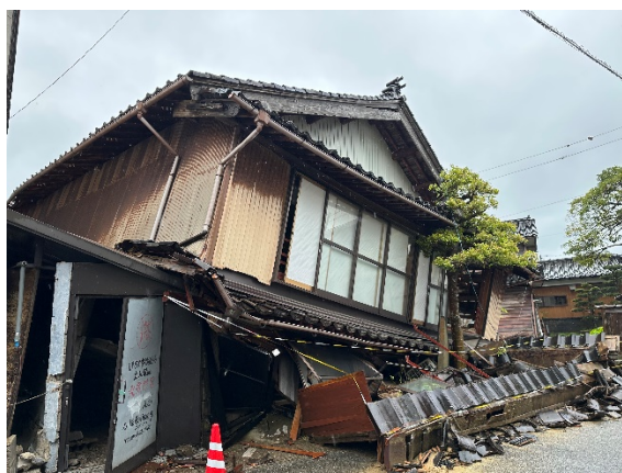
写真1-1 1階の壁が少ない倒壊した住宅
