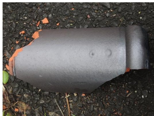
写真 3.4 脱落した棟瓦の状況
