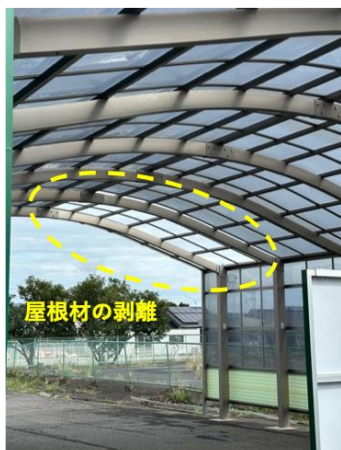
写真 3.5 カーポートの屋根材の剥離状況
