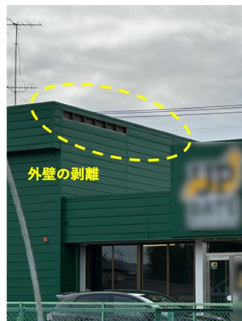
写真 3.6 外壁の剥離状況
