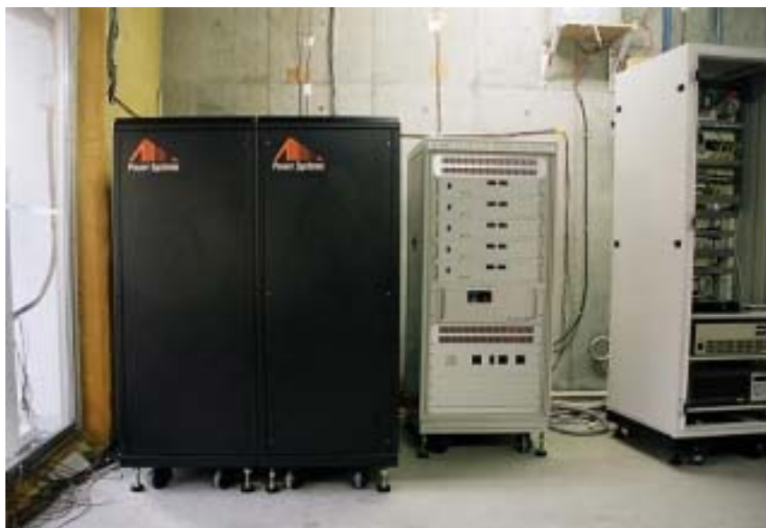
写真1 プロトタイプ概観 <左より、キャパシタ、同制御装置、全体システム制御装置>
