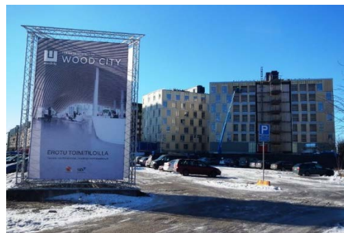
建設中の8階建共同住宅・事務所・ホテル（ヘルシンキ・フィンランド）
