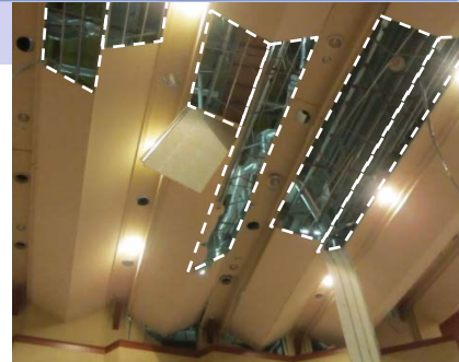
写真1 複数の勾配から成る天井の地震被害 3)
