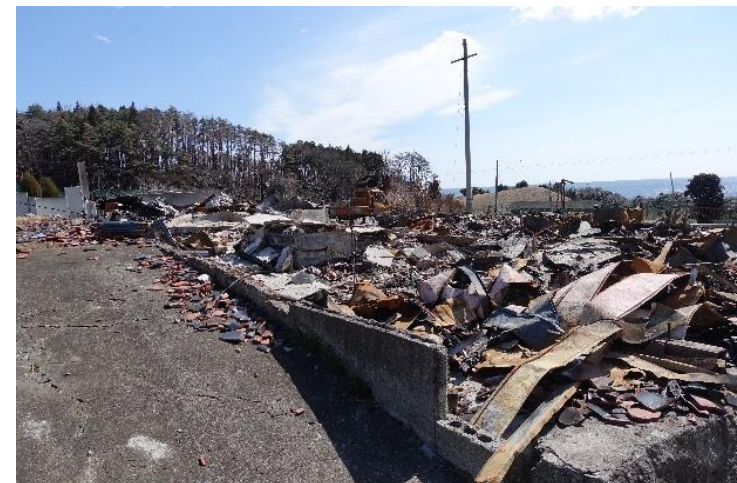
中央の山林付近(東側)の2棟並んだ建物被害
