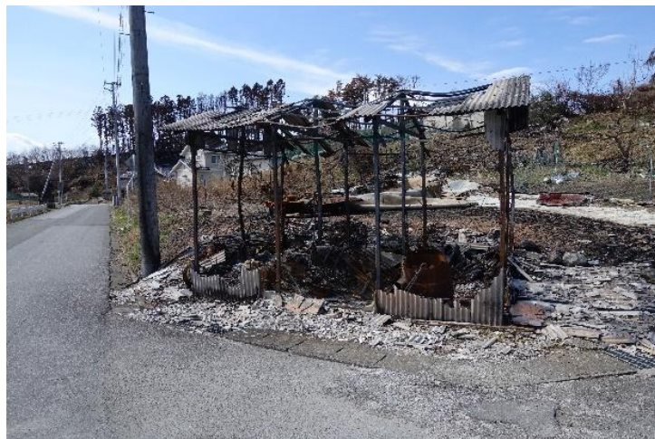
簡易な構造物の焼損被害
