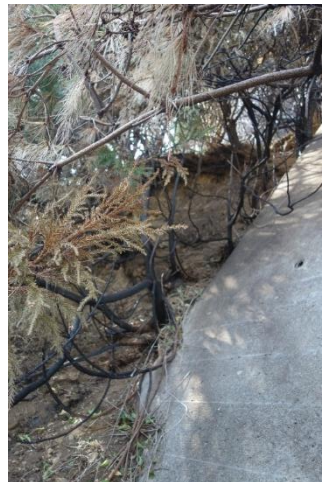
擁壁上の山林地表の焼損
