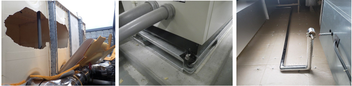
図 福島県沖を震源とする地震における設備関係の被害事例
