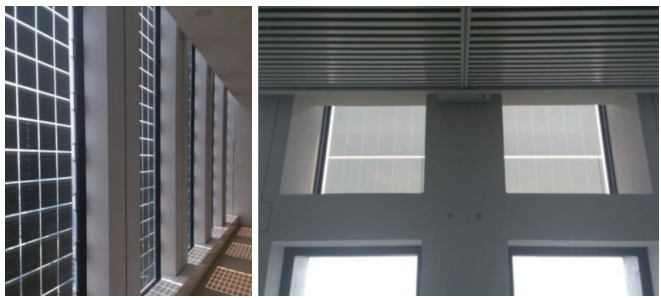
太陽光パネルは、共用部には発電効率の高い多結晶型(左)、執務室等には透過性のある薄膜型(右)を採用
