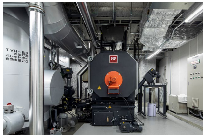
ペレットボイラ (200kW)
