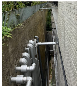
② 免震ピット地球側から 接続された配管
