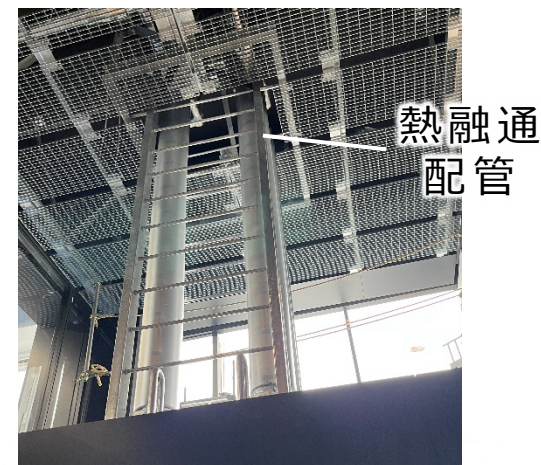
熱融通配管（北庁舎側）
