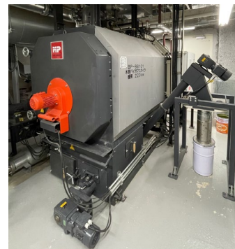
④ 木質ペレット ボイラー
