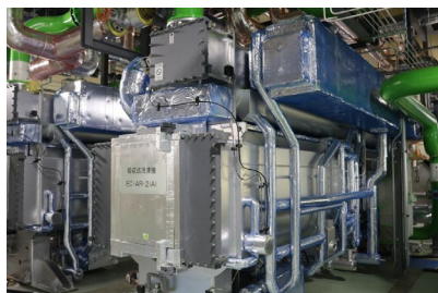
吸収式冷凍機
