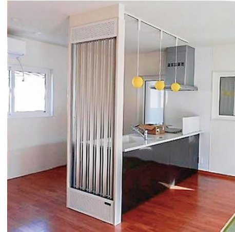
写真1 エアコン冷媒未利用熱方式の放射パネル設置例
